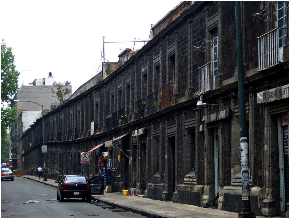
Figura 1.3 Asentamiento de un edificio de mampostería simple en el Centro de la Ciudad de México. Fuente http://geotecnia-sor.blogspot.com/2010/10/definicion-de-ingenieria-geotecnica.html
