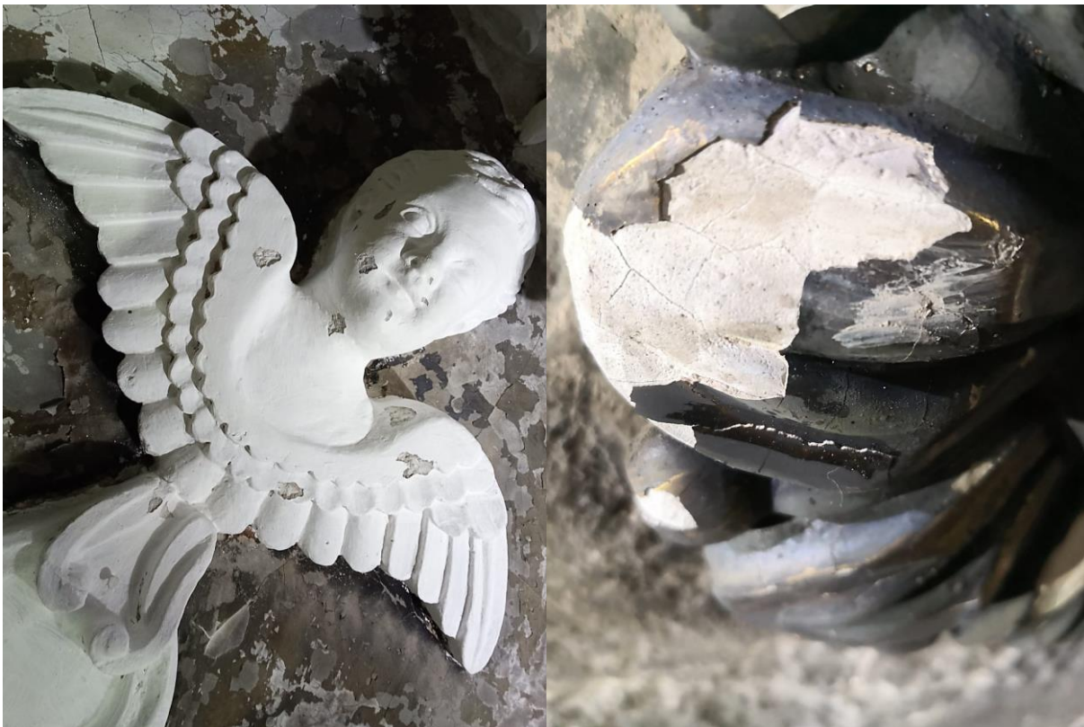
Figura 43. Registro fotográfico de daños en las yeserías ornamentales de la parroquia de la Santa Veracruz, previo a la intervención (2021).
