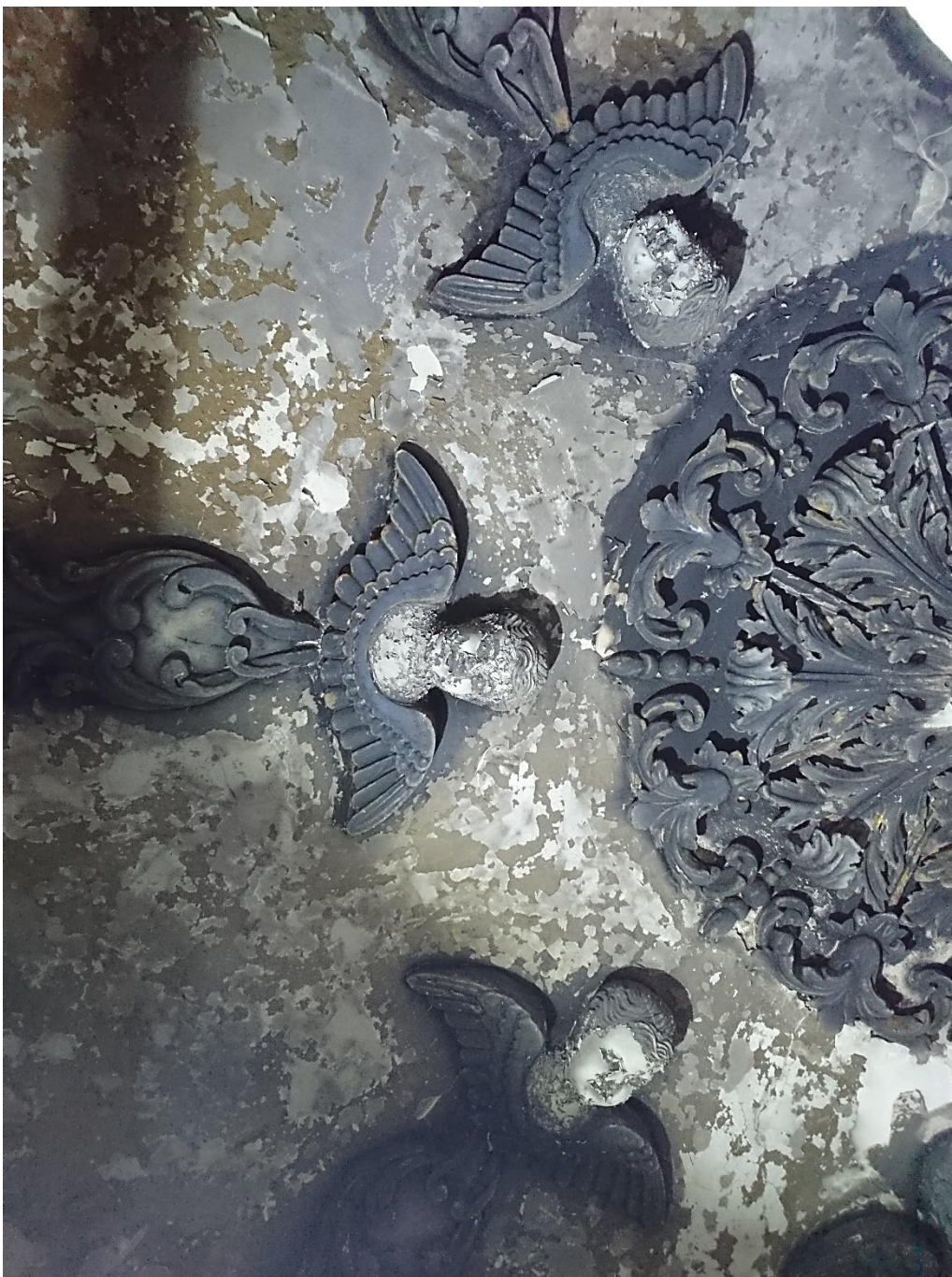
Figura 39. Registro fotográfico de daños en las yeserías ornamentales de la parroquia de la Santa Veracruz, previo a la intervención (2021).
