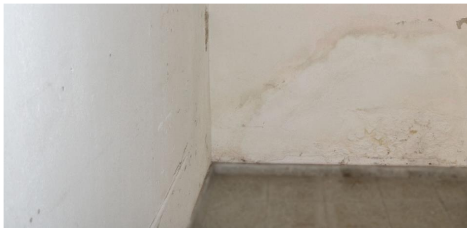
Figura 20. Humedad por capilaridad.
