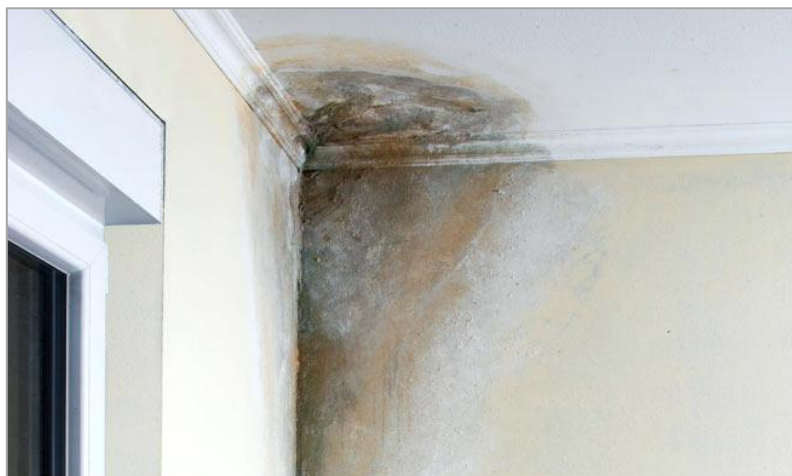
Figura 21. Humedad por filtración.
