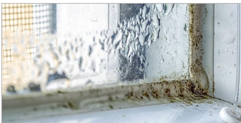
Figura 22. Humedad por condensación.
