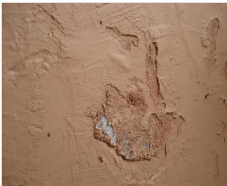
Figura 10. Ocultamiento de patologías en muros.
