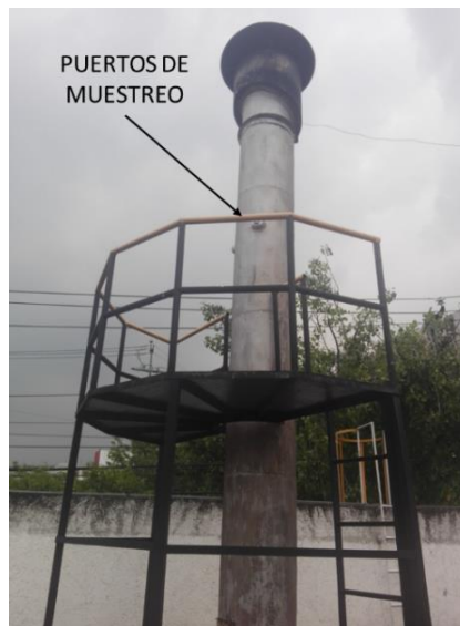
Figura 8. Chimenea con puertos y plataforma de muestreo
