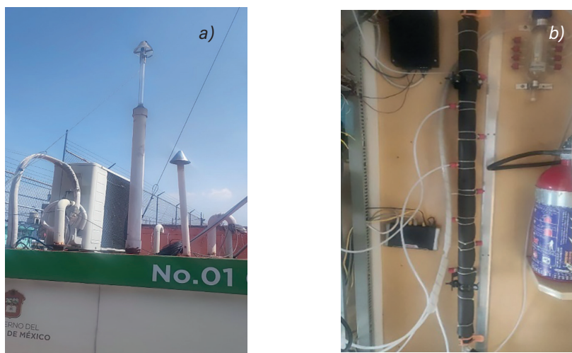
Figura 2.6a Toma de muestra en el techo de la estación. 2.6b Manifold aislado para evitar condensación (Fotografía: R. Castañeda).
