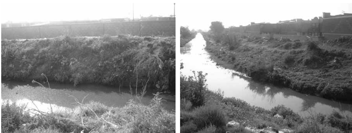
Canal de Cartagena con agua negra producto de los desechos industriales y habitacionales
