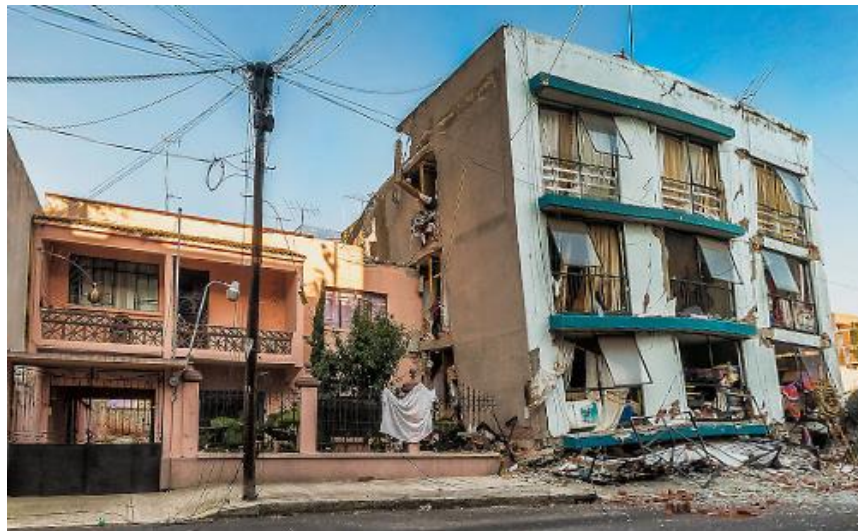
Figura 2.4. Colapso de casa y edificio antiguo en la colonia Portales Norte, Saratoga 714 y 720 respectivamente durante el sismo del 19 de septiembre de 2017 (imagen obtenida de google maps)
