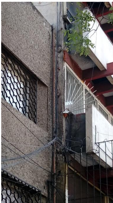
Figura 2.8. Daño presentado en el tercer piso por choque estructural en el edificio Yucatán 20 (Colonia Roma Norte) por golpearse con el edificio vecino de tres niveles durante el sismo del 19 de septiembre de 2017
