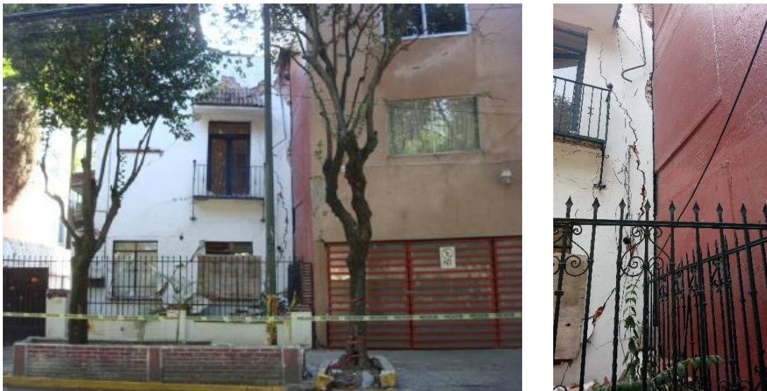
Figura 2.5. Daño grave en casa antigua en Plaza Popocatepetl 46 (Hipódromo Condesa) por choque estructural durante el sismo del 19 de septiembre de 2017 (Tena Colunga 2018)
