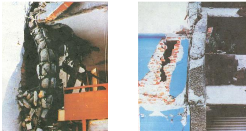
Figura 2.2. Daños por choque estructural durante el sismo del 19 de septiembre de 1985 (Fundación ICA 1988)
