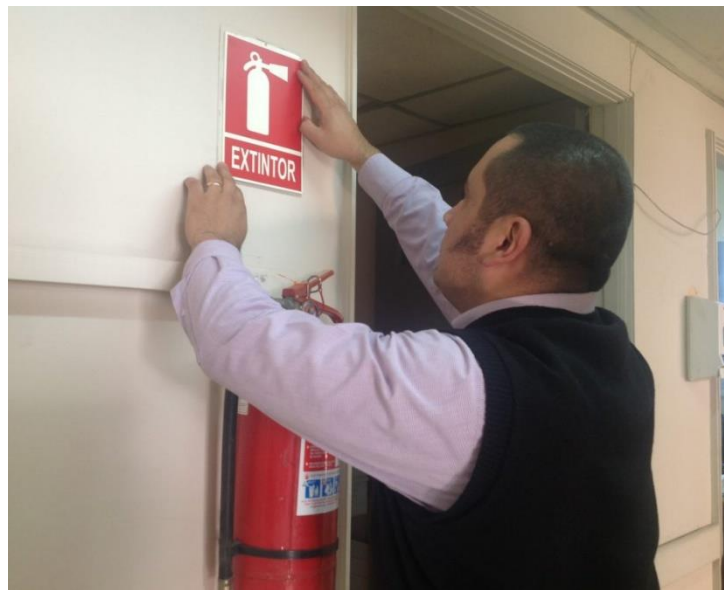
Ilustración 48. Colocación de extintor en el área administrativa.
