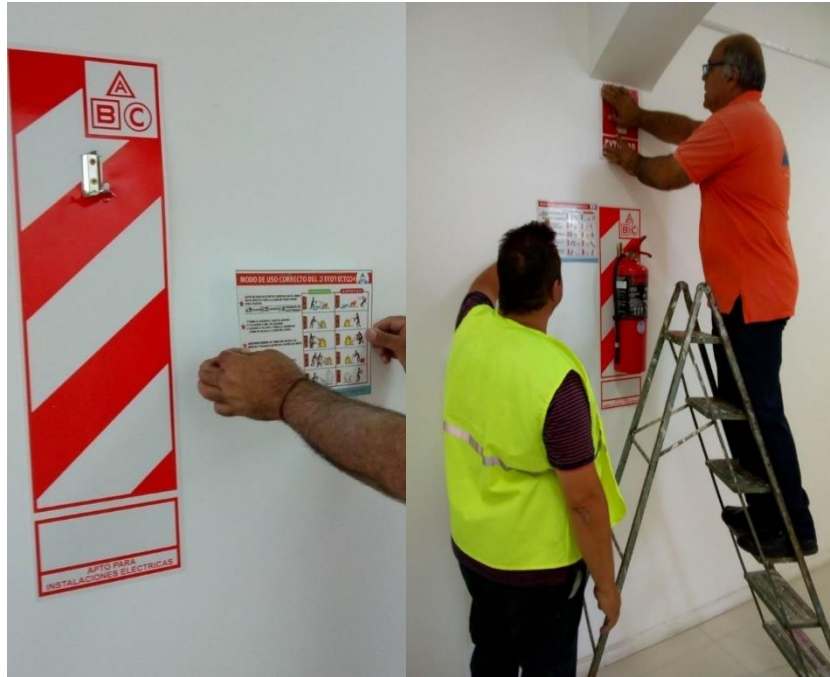
Ilustración 49. Colocación de extintores en la empresa.
