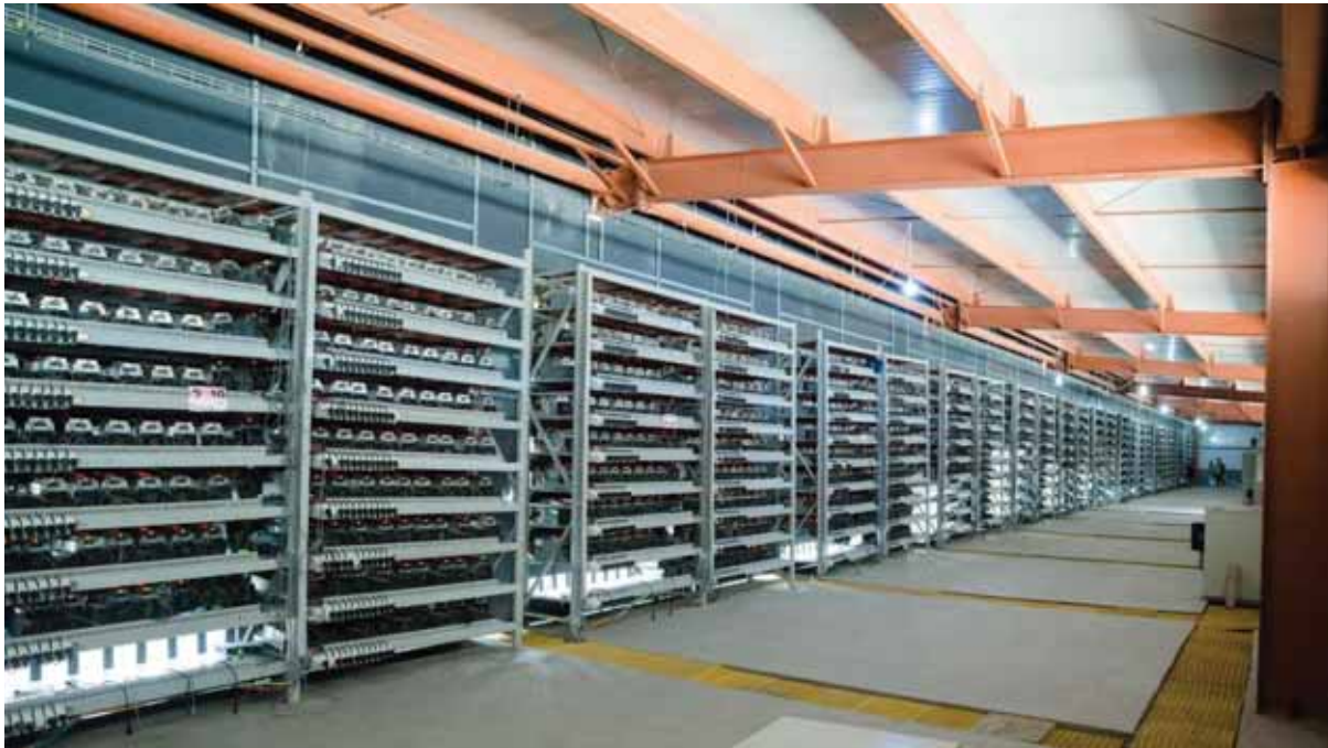
Figura 7. Imágenes de un datacenter para minar “en la nube” www.qz.com
