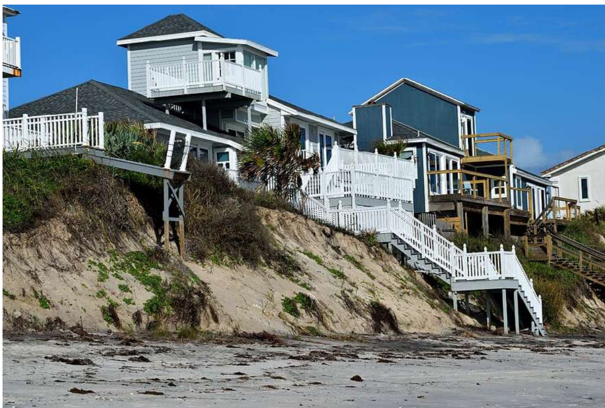
Figura 4. Erosión de la playa en la costa cerca de San Agustín, Florida.
