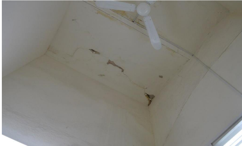
Figura 22. Daño estructural, grieta en salón oriente del patio central. Fuente: Karina M. A.
