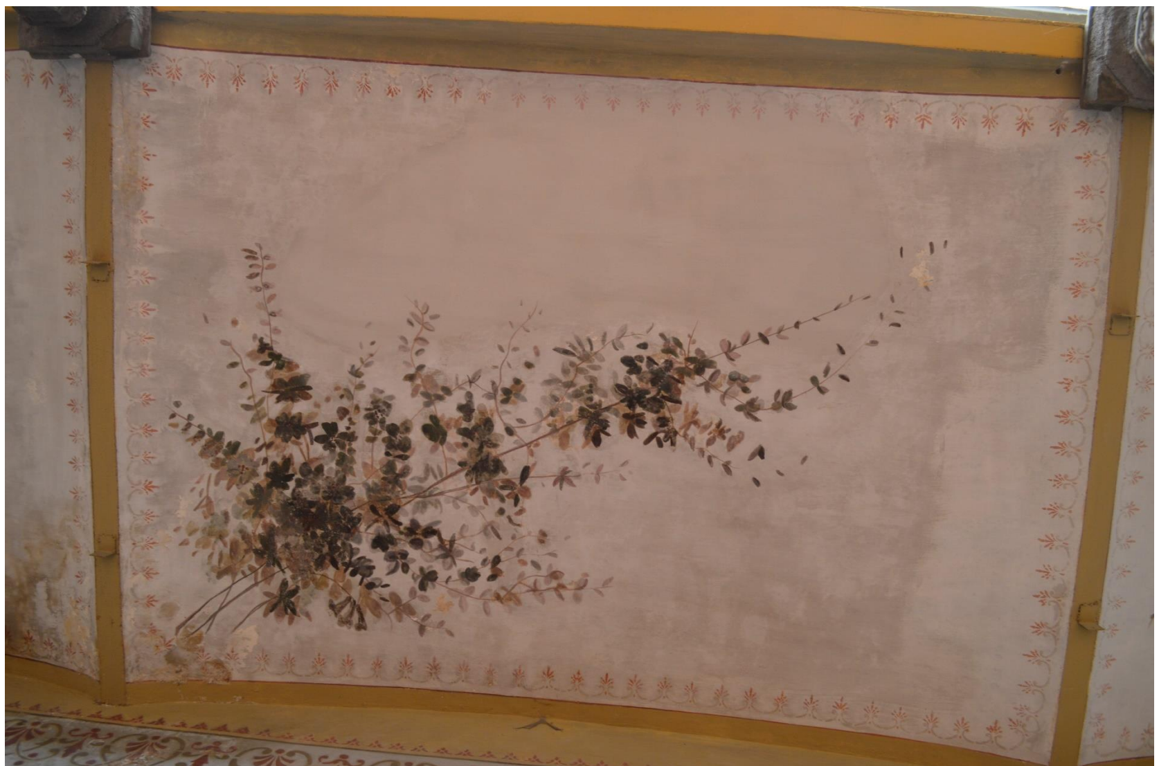
DETALLE 8. Motivo floral, ascendente de costado inferior izquierdo a costado superior derecho. Estado de conservación: presenta eflorescencias salinas y marcas de humedad en costado inferior izquierdo.
