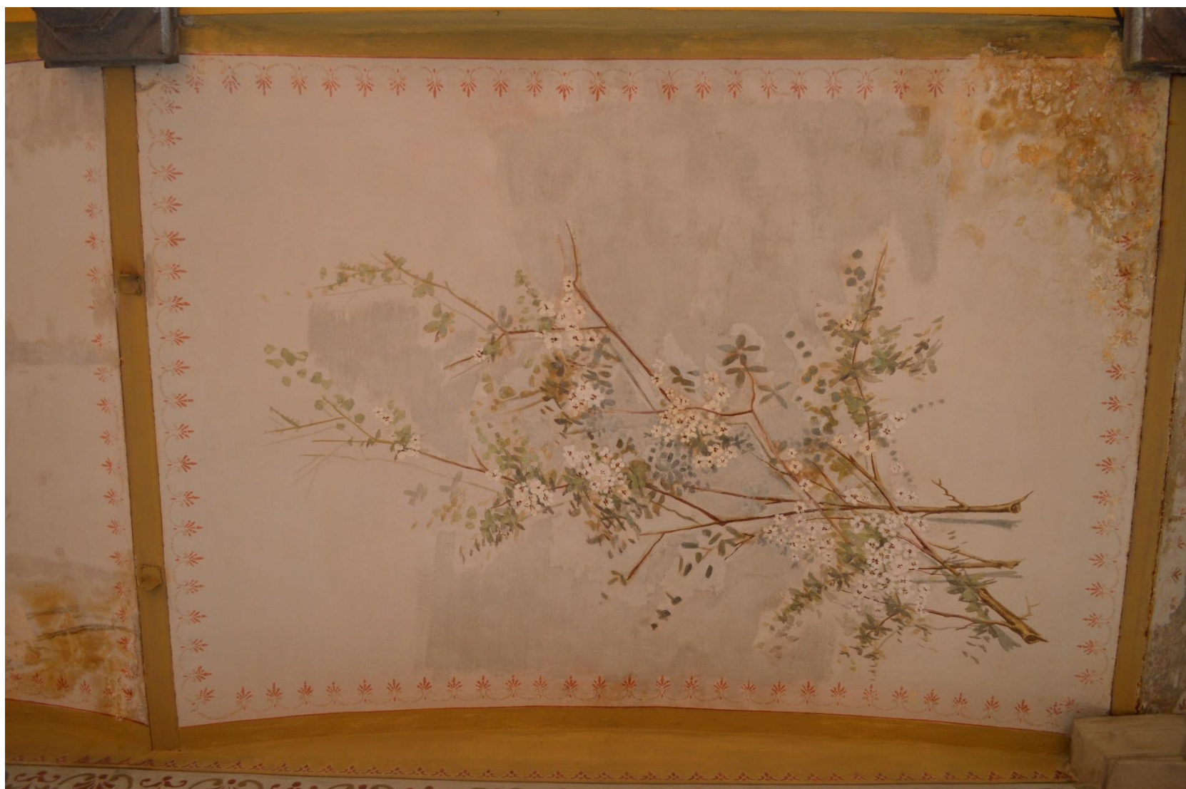
DETALLE 2. Motivo floral, ascendente de costado inferior derecho a costado superior izquierdo. Estado de conservación: presenta eflorescencias salinas, marcas de humedad en margen superior derecho.
