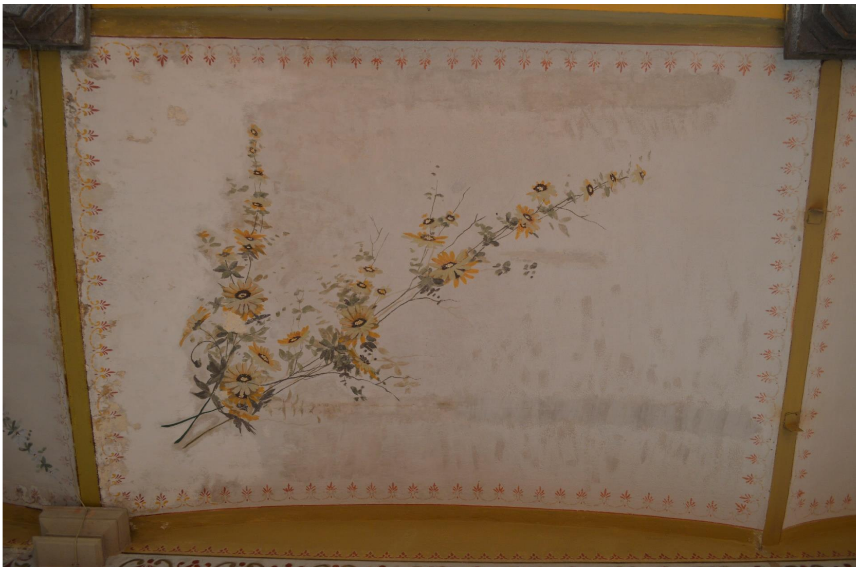
DETALLE 14. Motivo floral, ascendente de costado inferior izquierdo a costado superior derecho. Estado de conservación: presenta marcas de humedad generales y eflorescencias salinas.
