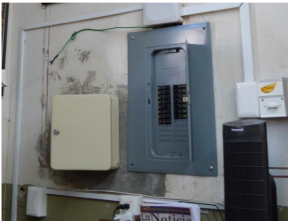
Figura 36. Tablero de distribución actual. Fotografía: Karina M.A.
