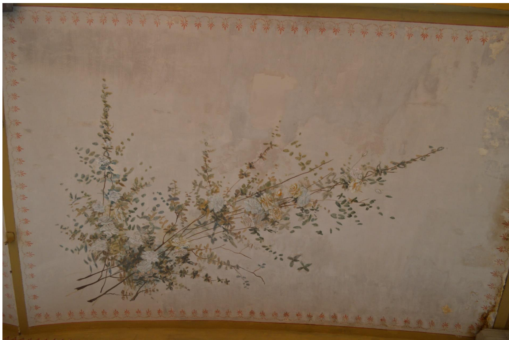
DETALLE12. Motivo floral, ascendente de costado inferior izquierdo a costado superior derecho. Estado de conservación: presenta marcas de humedad generales y eflorescencias salinas.
