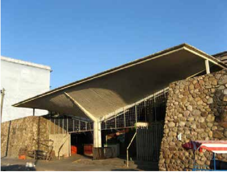
Fig. 111. Fachada donde se observa el detalle de uno de los paraguas del desaparecido Mercado de Arriaga.
