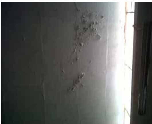
Fig. 94 Detalle de los daños a causa de la humedad, desprendimiento de pintura vinílica, 2012. Fotografía: Luis Manuel Chacón
