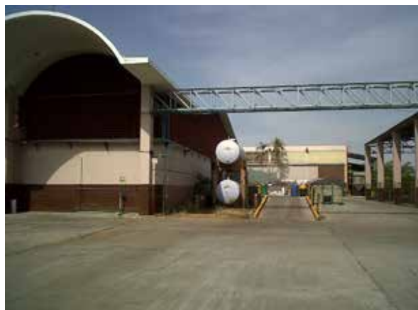
Fig. 87 Estado actual de la fachada de la nave principal, 2012. Fotografía: Luis Manuel Chacón
