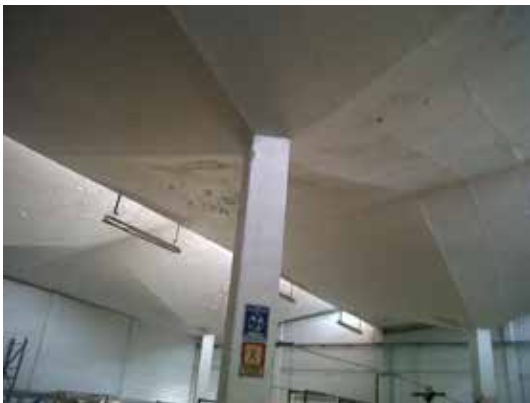
Fig. 93 Detalle de los daños a causa de la humedad en los paraguas de las bodegas, 2012. Fotografía: Luis Manuel Chacón
