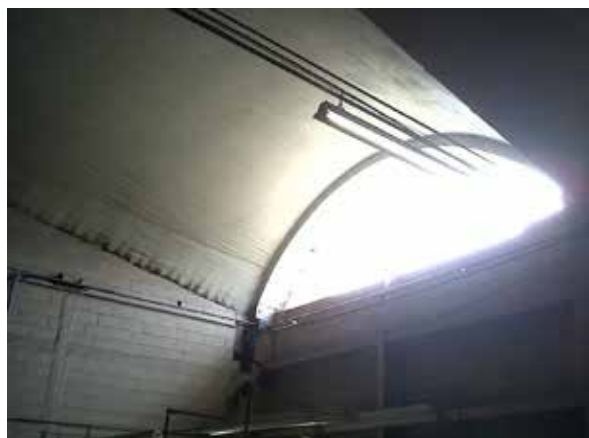
Fig. 89 Estado actual de la celosía formada con piezas de barro, 2012. Fotografía: Luis Manuel Chacón
