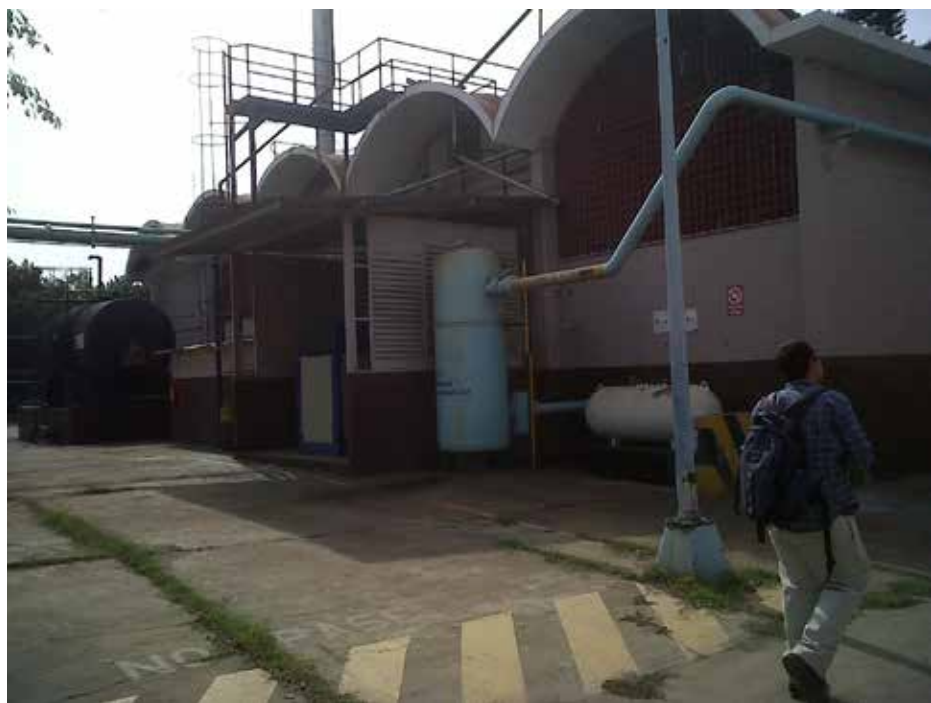
Fig. 86 Estado actual del interior de la fachada del cuarto de máquinas (2012). Fotografía: Luis Manuel Chacón
