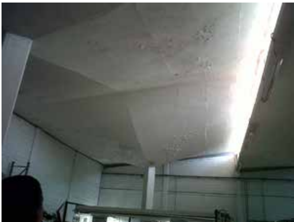
Fig. 92 Interior del área de bodegas, se observan los paraguas dañados que componen el edificio, 2012. Fotografía: Luis Manuel Chacón
