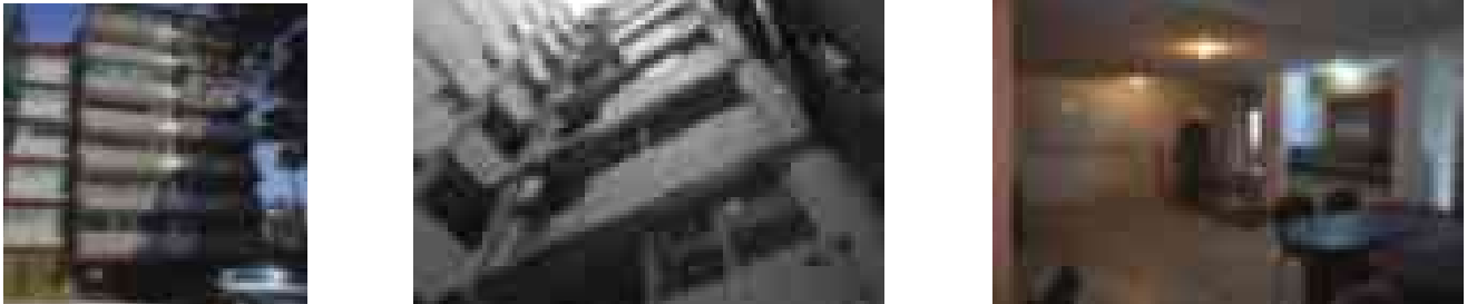
Fig. A.5: Daños presentados en el edificio localizado en Sinaloa 93
