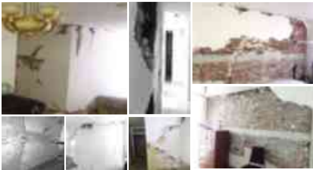
Fig. 4.5: Daños presentados en los muros de los departamentos.
