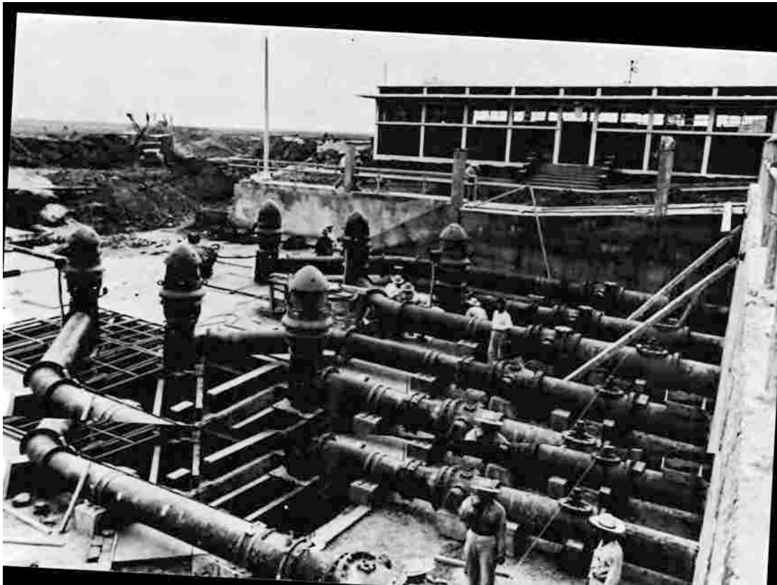
Figura 104. Casa de Bombas, tuberías y válvulas del Sistema Lerma en el Alto Lerma, en D.D.F., D.D.F. de Agua Potable para la Ciudad de México. Sistema Lerma, 1951.
