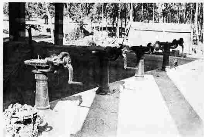
Elevadores de las compuertas.
