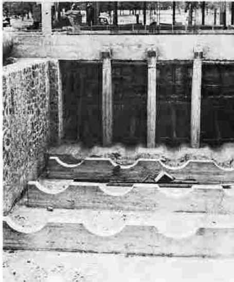
Silleros para las tuberías de conexión de la caja de distribución a los tanques de Dolores.
