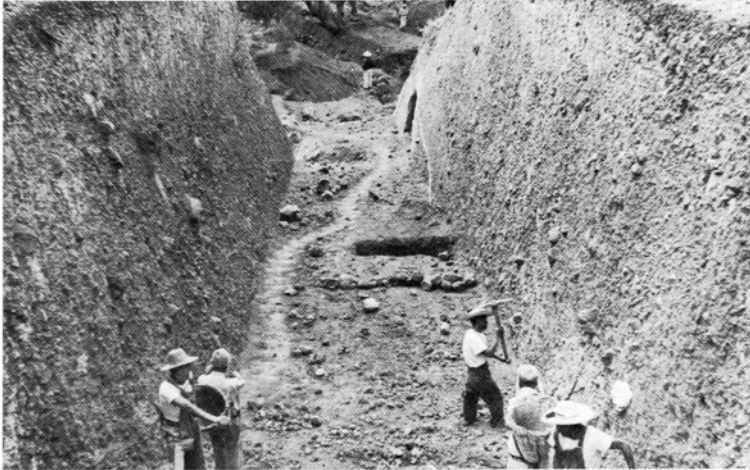
Rampa de la tubería de presión para la planta de San Joaquín.
