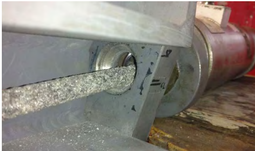
Figura 6-61 Punto de salida de barra de rótula de apoyo
