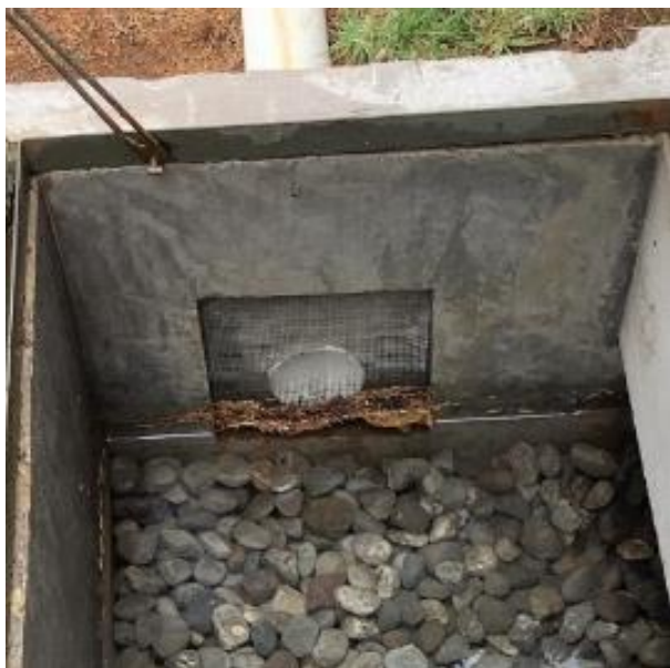
Figura 5. Filtración del agua inmediatamente antes de entrar a la cisterna con filtros a base de gravas de diferentes diámetros y filtro tipo criba en la tubería de PVC
