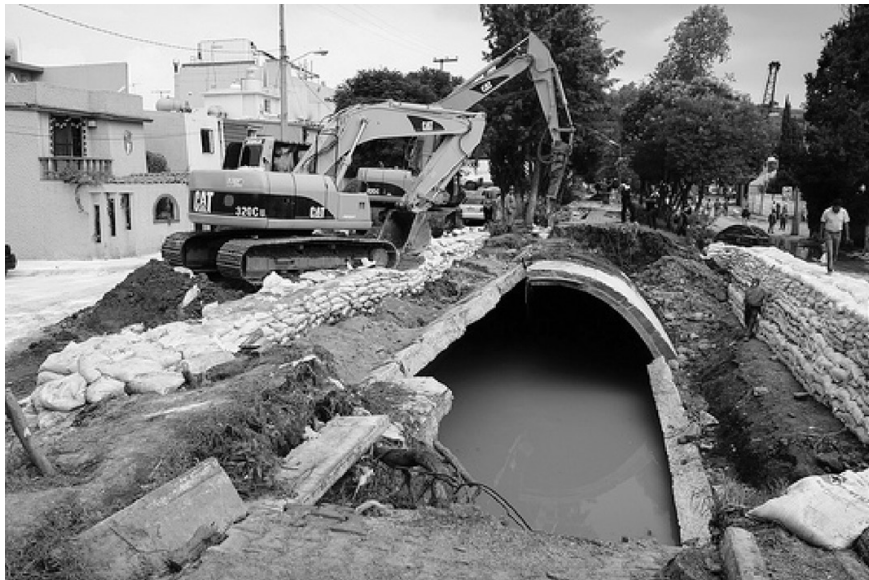
Imagen del Drenaje profundo Reventado en Valle Dorado Tlalnepantla Edo de México.
