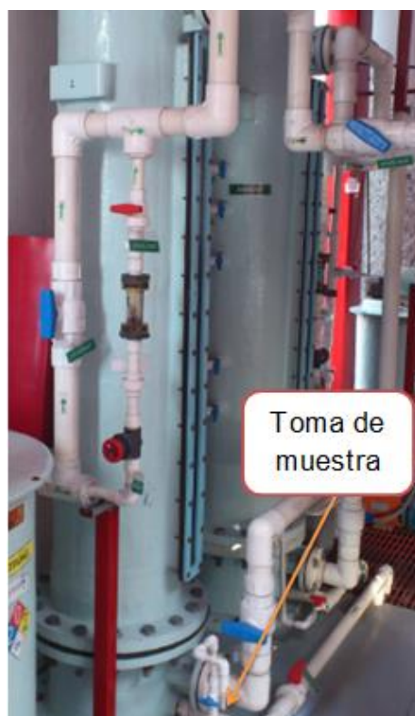
Figura 4.3 Columnas de filtración de la PPTAR
