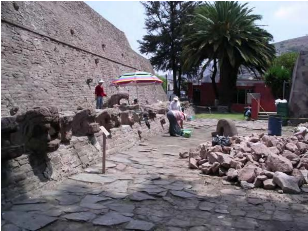
Figura 17. Trabajos de consolidación de los cuerpos de las serpientes del lado sur del Coatepantli (2010).
