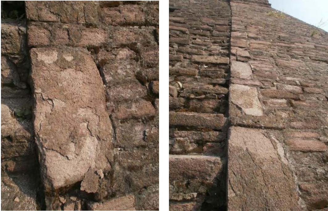
Figura 71. Deterioro de tipo deslaminación, subtipo exfoliación.
