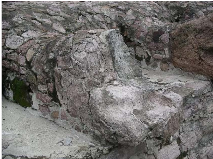
Figura 72. Detalle del deterioro de una cabeza de serpiente. Tipo deslaminación, subtipo exfoliación.
