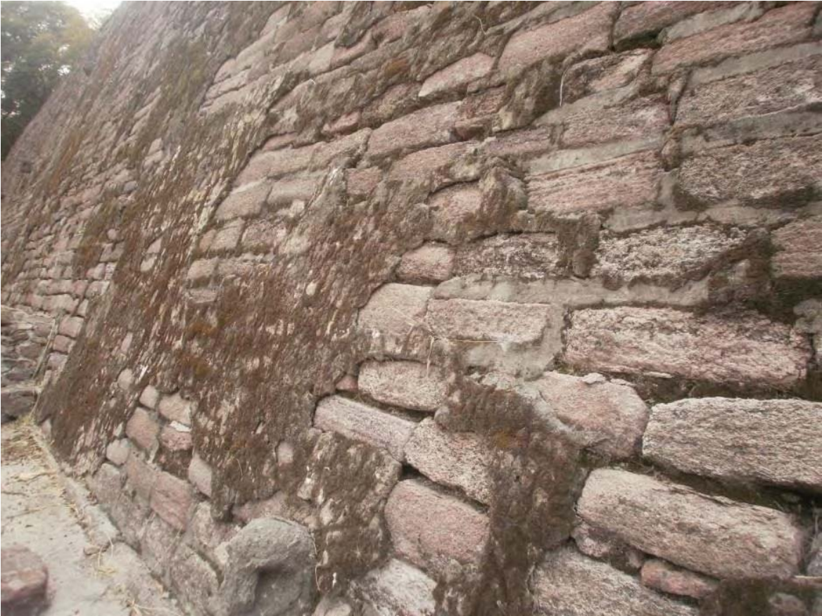
Figura 78. Crecimiento de musgo en la superficie de aplanados (2014).
