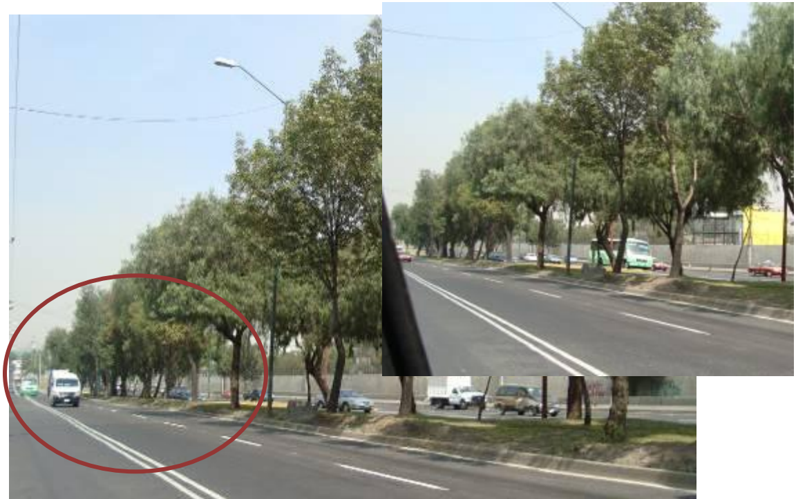
Fig. 32. Tramo hundido de la calzada Ignacio Zaragoza en el que se estanca el agua que baja del cerro del Marqués.
