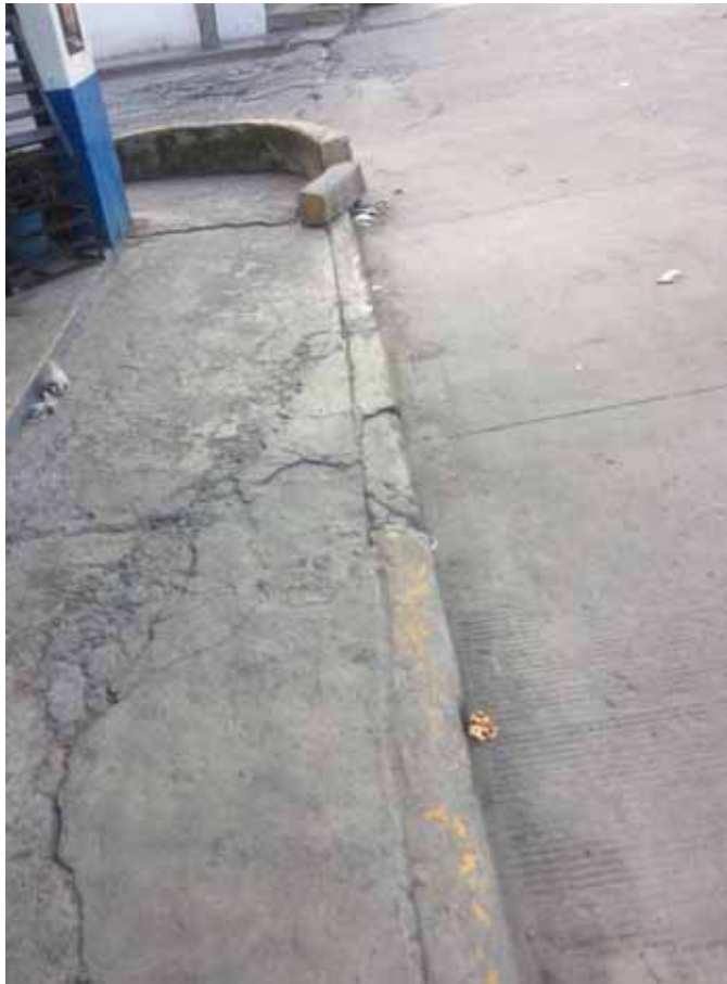
Foto 1. Guarnición perteneciente a la Avenida El Tesoro en mal estado
