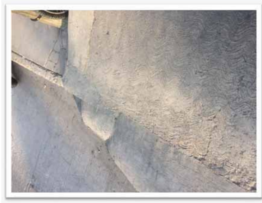
Foto 7. Rampa adecuada por los habitantes del inmueble frente a la banqueta
