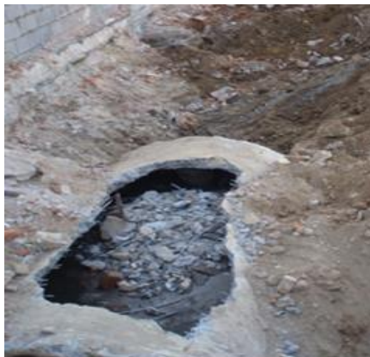
Figura 4.2 Depósito de combustóleo fracturado (Fotografía propia ATS)
