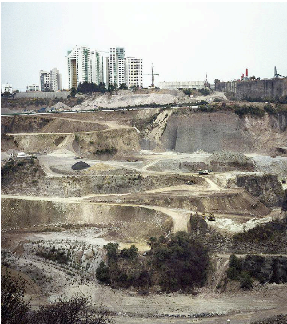
Figura 181 Excavación de proyecto en Santa Fe, Jesús del Monte No. 1 Ciudad de México. López L. Pablo (2007). Pablo Lopez Luz: An Explorer of Space and Time [imagen de internet]. Talking Pictures. https://talking-pictures.net.au/2020/01/20/pablo-lopez-luz-an-explorer-of-space-and-time/
