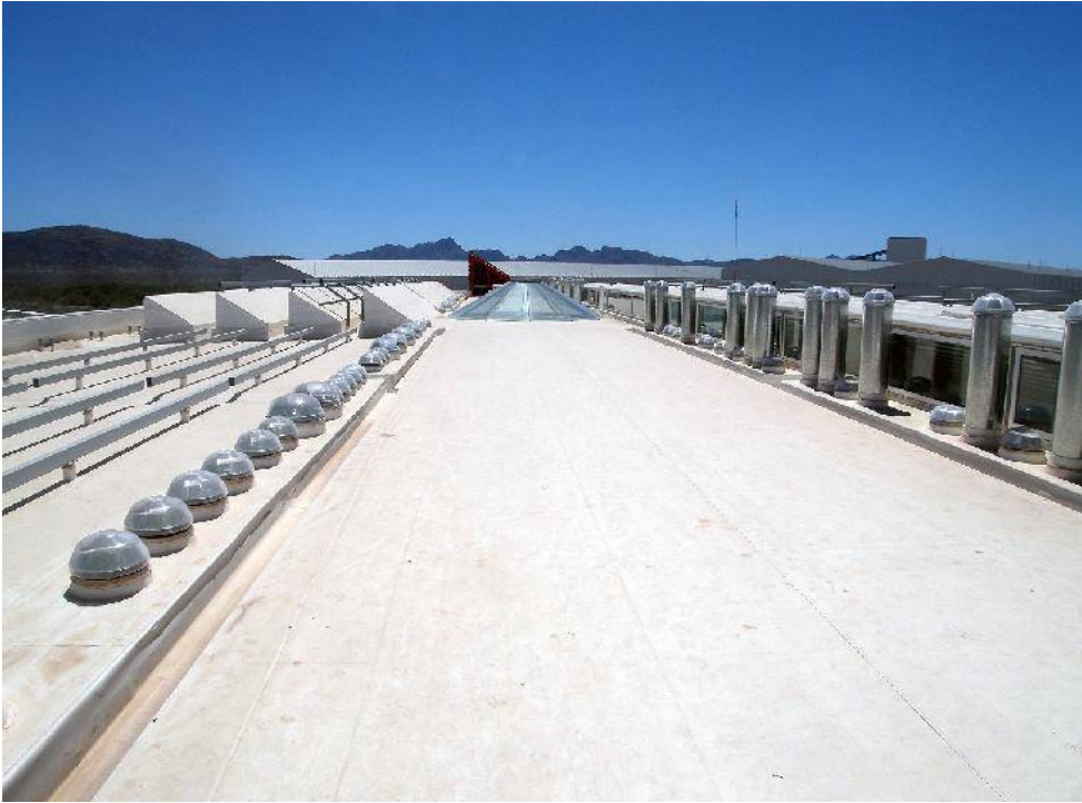
Figura 139. Luminoductos en la azotea del Edificio de Oficinas de la Planta de Cemento Holcim-Apasco en Hermosillo, Sonora.
