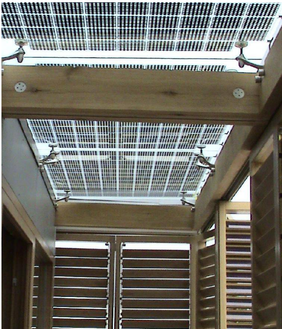
Figura 176. Cubierta fotovoltaica para producción de energía eléctrica Proyecto: Technische Universität Darmstadt Imagen: A. Figueroa (2007)
