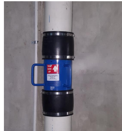
Figura 122. Filtro de Bajante Pluvial Instalado Fuente: hidropluviales.com
