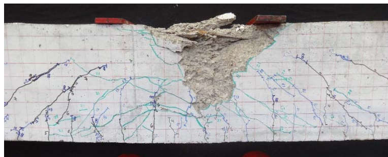
Figura E.31 Mecanismo de colapso, trabe 45-4E-1.5
