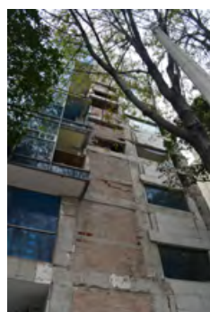
Figura 7. Alteraciones en edificio (Aníbal Figueroa).
