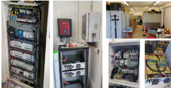
Figura 9. Instalación eléctrica interna (Spyridon Vassiss).
