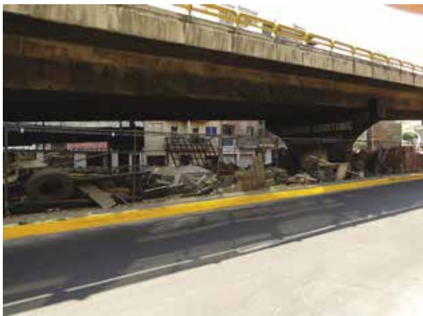
Imagen 3.24: Bajo Punte “Juan Escutia” antes de la implementación del proyecto. / Image 3.24: Bridge Underpass “Juan Escutia” before the project implementation.
