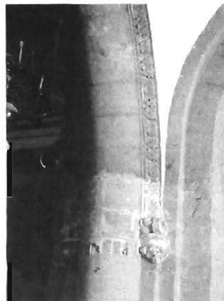
Foto 2. En esta foto se nota la eliminación de férulas de concreto de las columnas descubiertas (véase apéndice 2). OMGT, septiembre de 2008
