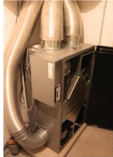
Figura 10. Intercambiador térmico. Foto: Michael Peters.
