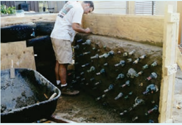
Figura 12. Muro con botellas, arquitectura experimental, sus resultados son poco aplicables a una realidad masiva como la actual.
