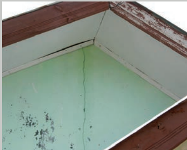
Figura 4. Banda Aceh. Se observa la mala calidad de las obras, fisura ancha en la mampostería del frontón. (Foto: Ibid. ).
