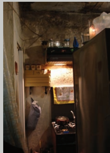
Figura 24. Filtración en el techo de la cocina de la casa 1. Fuente: autora/2007.
