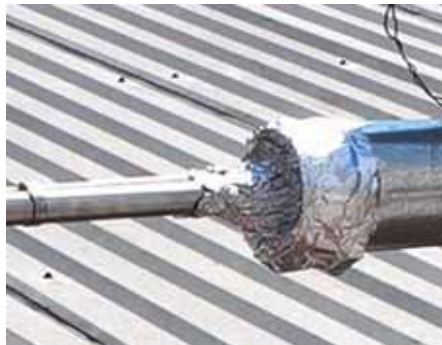
Figura 17. Celda electroquímica en chimenea
