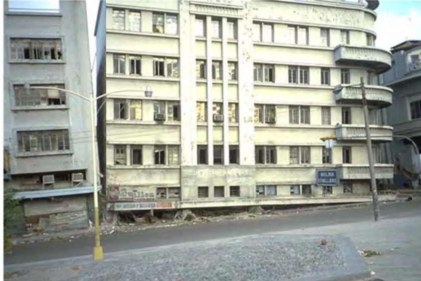
Figura 6.6 Colapso de Edificio Rubén Darío (Anderson 1987)
