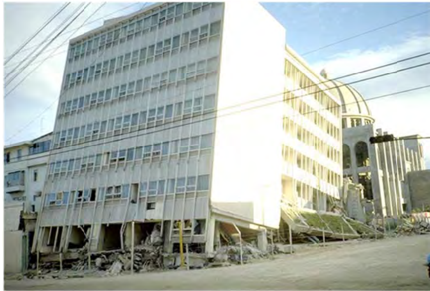
Figura 6.4 Colapso de los dos pisos inferiores del antiguo Gran Hotel de San Salvador (Anderson 1987)
