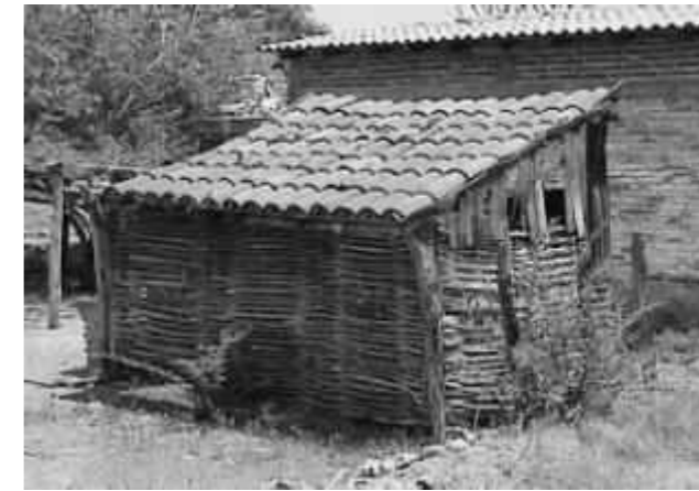
Ilustración 36. Cubierta de teja en un caedizo. Fuente: Adecuación al medio ambiente de la arquitectura del Siglo XVIII en la Antigua Provincia de Colima.
