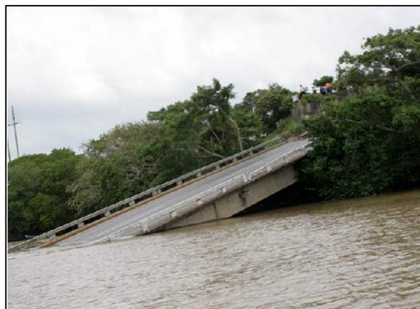
Figura 1.3 Colapso del puente Tonalá en el estado de Tabasco. (Referencia web-2)
