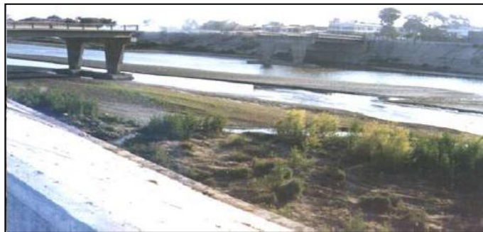
Figura 1.4 Falla por socavación del puente Bolognesi en Perú (Martínez, 2007)
