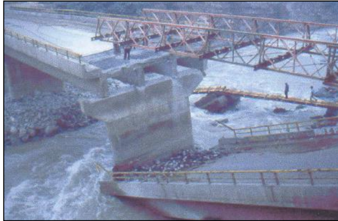
Figura 1.5 Falla del puente Huachipa en Perú por problemas de socavación (Martínez, 2007)
