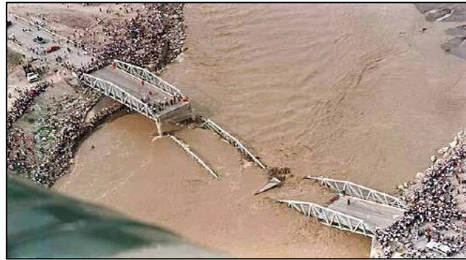
Figura 1.6 Falla por socavación del puente Saltur en Perú (Martínez, 2007)
