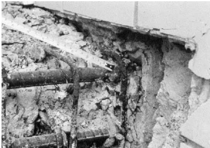
Figura 5. Rotura de varilla por corrosión en el Edificio Calipso
