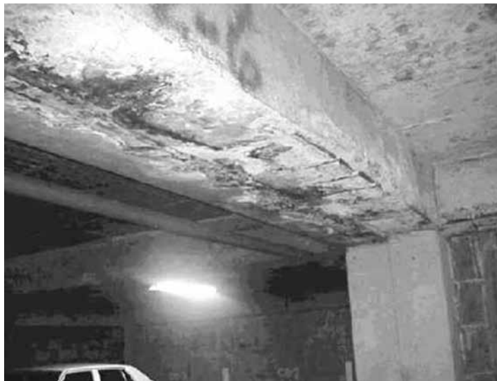
Figura 6. Daño en estructura por corrosión de acero de refuerzo.
