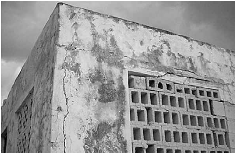
Figura 9. Condiciones inseguras causadas por la corrosión del armado de refuerzo.
