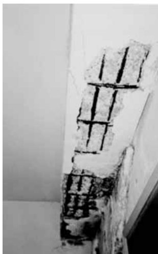
Figura 13. Oxidación en vigas
