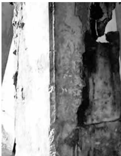
Figura 15. El concreto acusó entallamientos y erosión por ataque químico.
