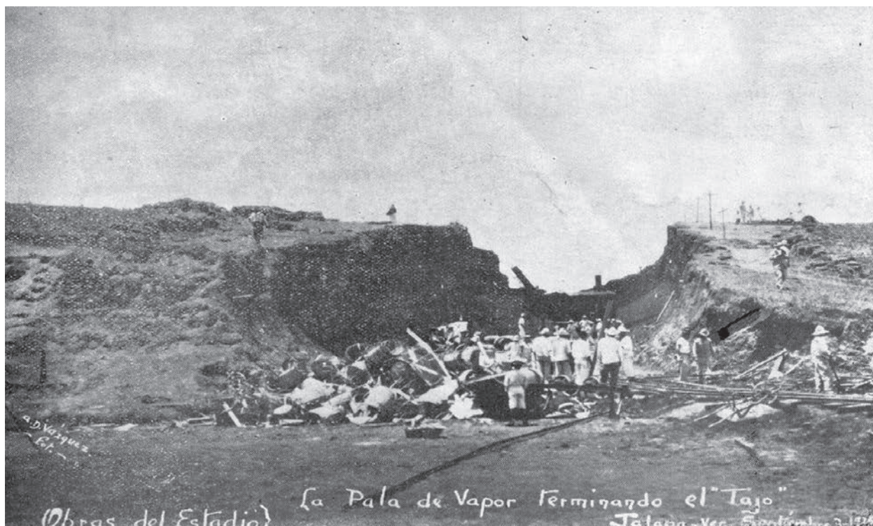
Figura 10. Obras del tajo que comunicará el estadio con el Dique. Fuente: H. Jara (1925).
