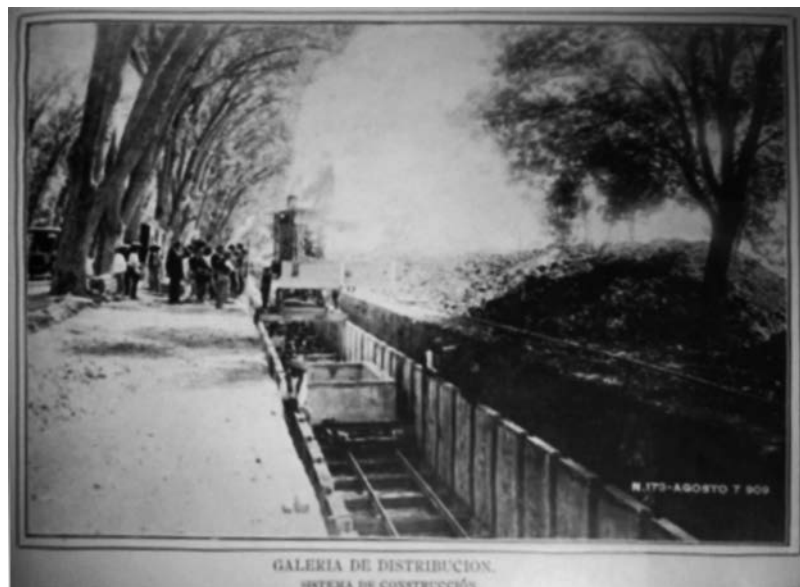
Figura 12. Construcción de la Galería. Fuente: Memoria de las Obras de Provisión de Agua Potable de la Ciudad de México, 1910.
