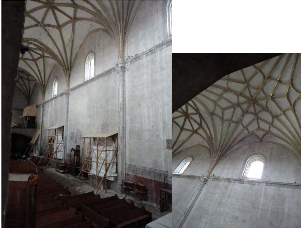
Figura 406. Huejotzingo, Pue. Ex convento San Miguel Arcángel. Interior del templo. Nave y presbiterio. Los muros y bóvedas presentan fracturas. En espera de trabajos de intervención. TMH 2018
