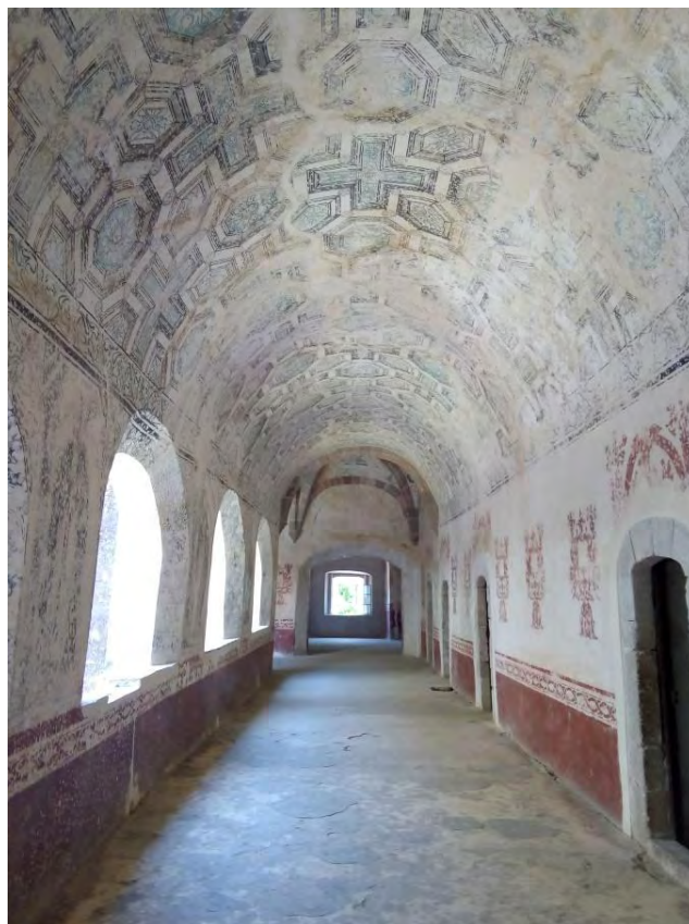
Figura 234. Tlayacapan, Mor. Ex convento San Juan Bautista. Claustro alto. Deambulatorio. Estado de conservación de la pintura mural en muros y bóvedas. TMH 2019
