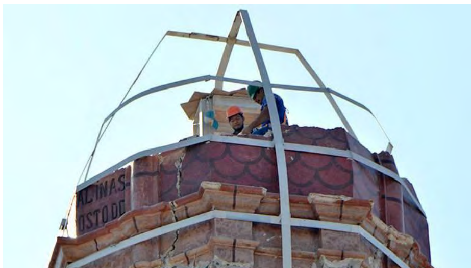
Figura 269. Cuernavaca, Mor. Ex convento La Asunción, hoy catedral. Afectaciones en el cupulín del campanario. Consultado el 20 de agosto del 2019 https://www.elsoldecuernavaca.com.mx/local/reconstruira-el-inah-el-cupulin-de-catedral-1917466.html
