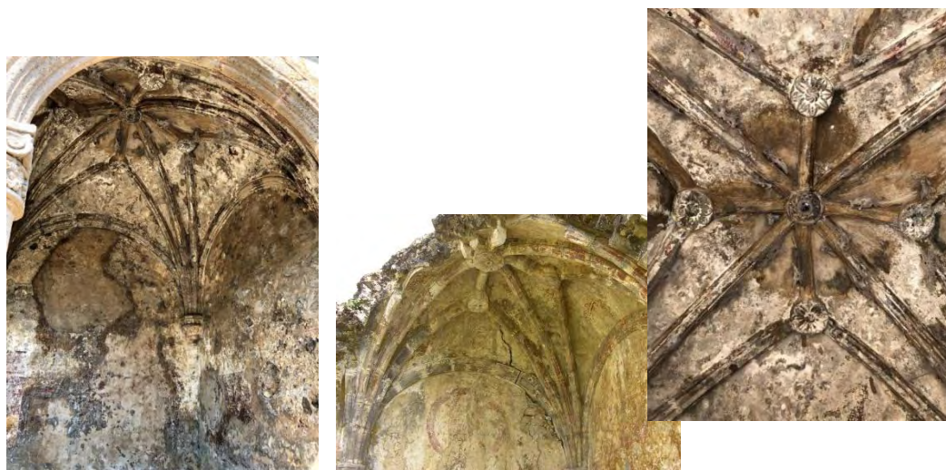
Figuras 216. Tepoztlán, Mor. Ex convento Nuestra Señora de La Natividad. Capillas posa, estado de conservación. TMH 2019
