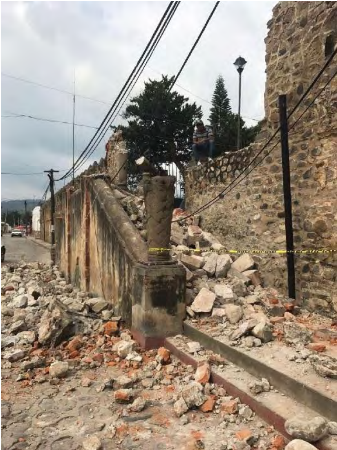
Figura 358. Ocuituco, Mor. Ex convento Santiago Apóstol. Derrumbe de arcada real en sismo del 19 de septiembre del 2017. Consulta 16 octubre 2019 https://www.launion.com.mx/morelos/cuautla/noticias/113463-devastados-monumentos-de-la-ruta-de-los-conventos.html
