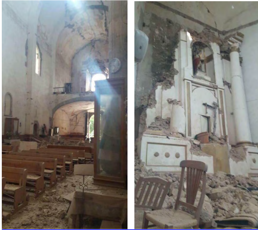
Figura 302. Tlayacapan, Mor. Ex convento San Juan Bautista. Templo. Primeras imágenes del interior publicadas después del sismo del 19 de septiembre del 2017. Consulta 23 de noviembre del 2019 https://www.zonacentronoticias.com/2017/09/pega-sismo-a-la-magia-de-morelos/
