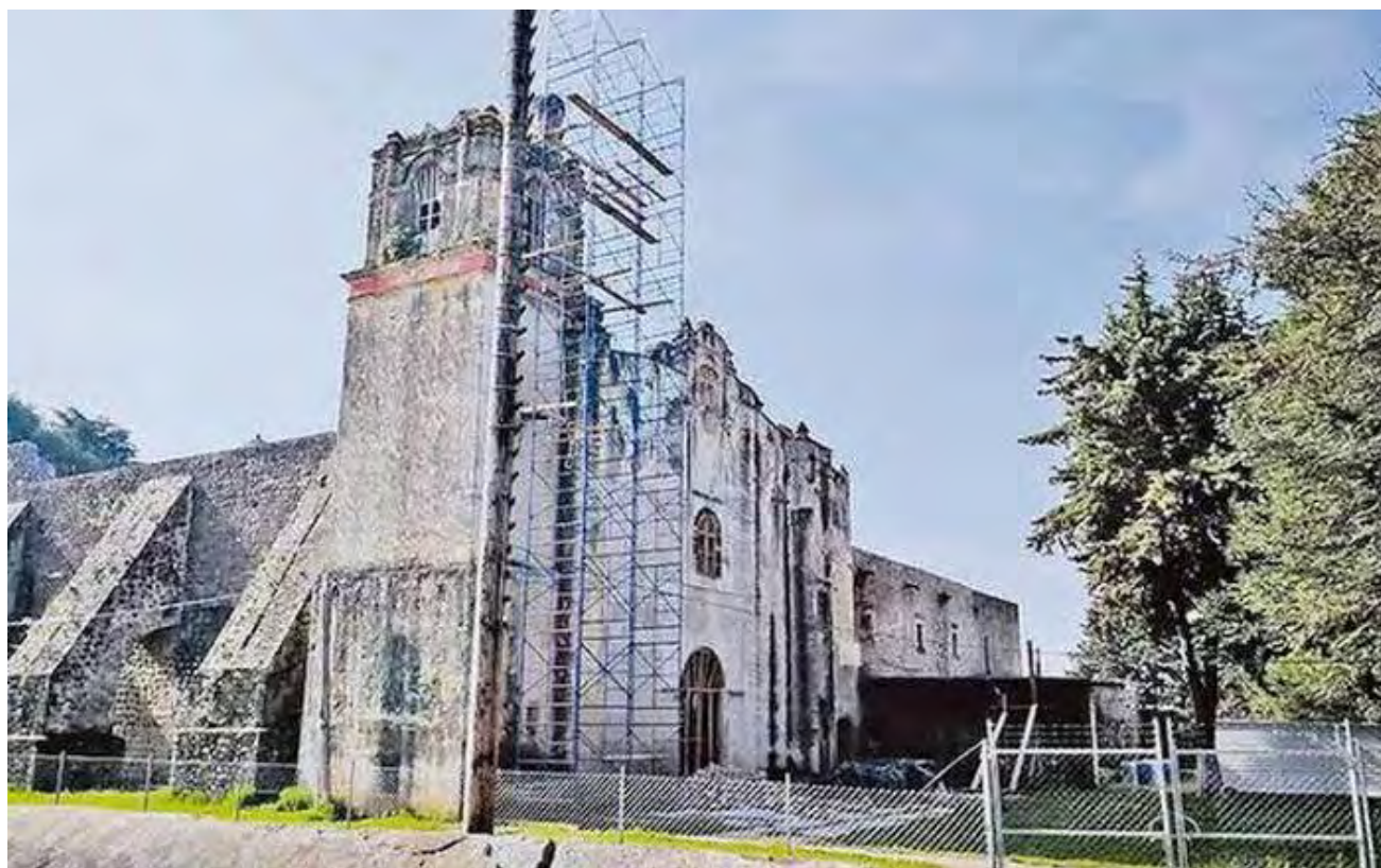
Figura 369. Tetela del Volcán, Mor. Ex convento San Juan Bautista. Proceso de trabajos de intervención en fachada y torre campanario. Consulta 26 de noviembre del 2019 https://www.elsoldecuernavaca.com.mx/local/especial-la-ruta-de-los-conventos-3768190.html
