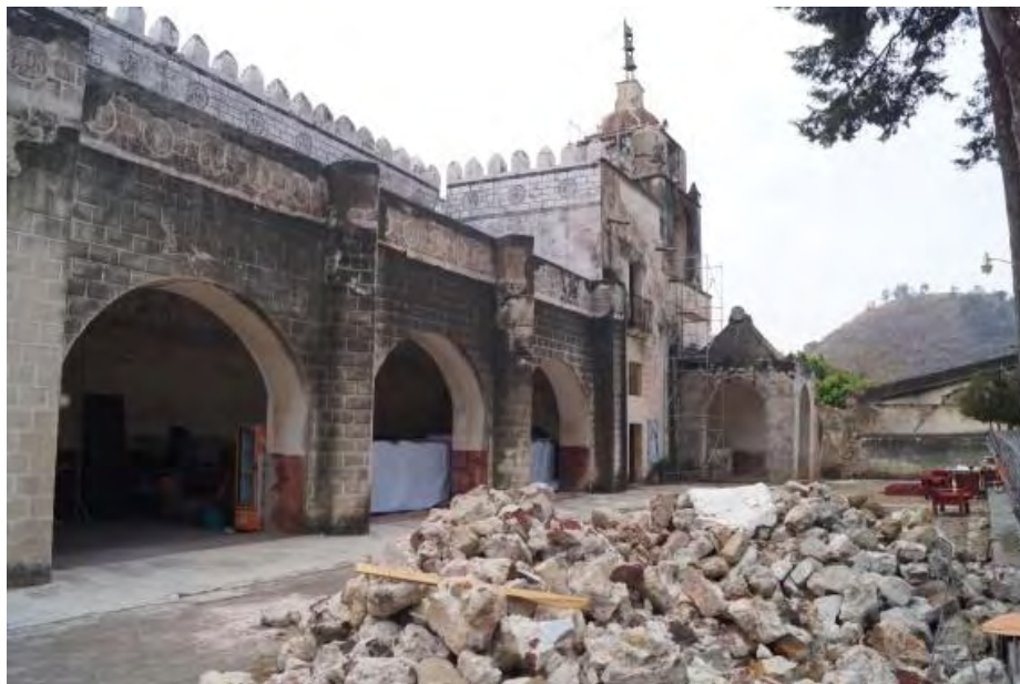
Figura 288. Totolapan, Mor. Ex convento San Guillermo. Portal de peregrinos. Acceso al convento. Concentración de materiales desprendidos como consecuencia del sismo del 19 de septiembre del 2017. Consulta junio del 2019 https://noticias.canal22.org.mx/2018/05/08/restauracion-del-convento-de-san-guillermo-en-totolapan-morelos
