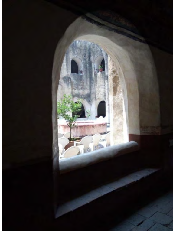
Figura 334. Atlatlahucan, Mor. Ex convento San Mateo Apóstol. Claustro, patio y deambulatorio. Uso provisional para realizar actividades religiosas. TMH 2019
