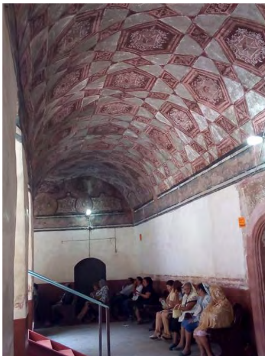
Figura 331. Atlalahucan, Mor. Ex convento San Mateo Apóstol. Claustro. Deambulatorio. El uso está destinado a las actividades religiosas, durante el proceso de trabajos de rehabilitación en la cubierta del templo. TMH 2019
