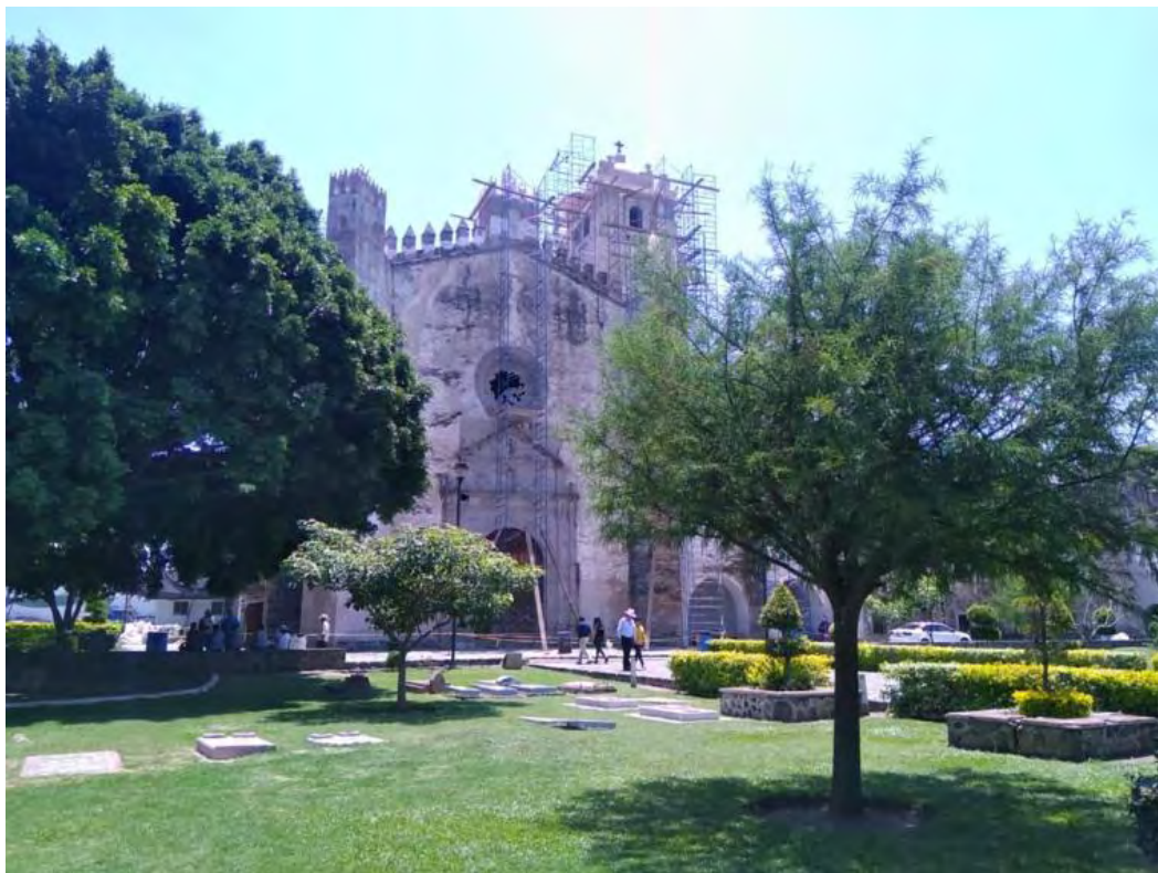
Figura 350. Yecapixtla, Mor. Ex convento San Juan Bautista. Templo. Trabajos de intervención. TMH 2019
