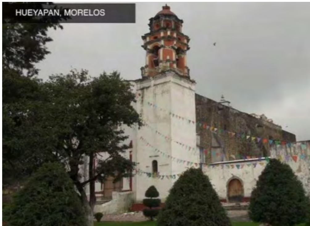
Figura 375. Hueyapan, Mor. Ex convento Santo Domingo de Guzmán. Torre campanario. Fracturas en estructura y desprendimiento de materiales. Consultado en agosto del 2019 https://noticieros.televisa.com/ultimas-noticias/sismo-tira-siglos-historia-iglesias-puebla-y-morelos
