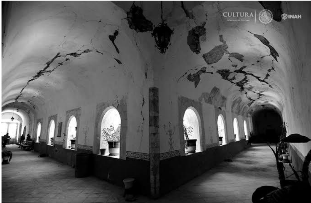
Figura 385. Zacualpan de Amilpas, Mor. Ex convento de la Inmaculada Concepción. Claustro alto: daños en bóvedas de deambulatorio, desprendimiento de aplanados. Consulta 28 de noviembre del 2019 https://restauracionpatrimonio.cultura.gob.mx/multimedia/detalle/214
