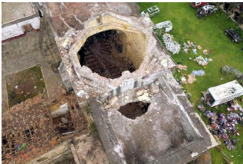
Figura 371. Hueyapan, Mor. Ex convento Santo Domingo de Guzmán. Colapso de cúpula en templo y derrumbe de cubierta en edificio conventual. Consultado el 18 de agosto 2019 https://www.jornada.com.mx/2018/01/30/politica/015n1pol
