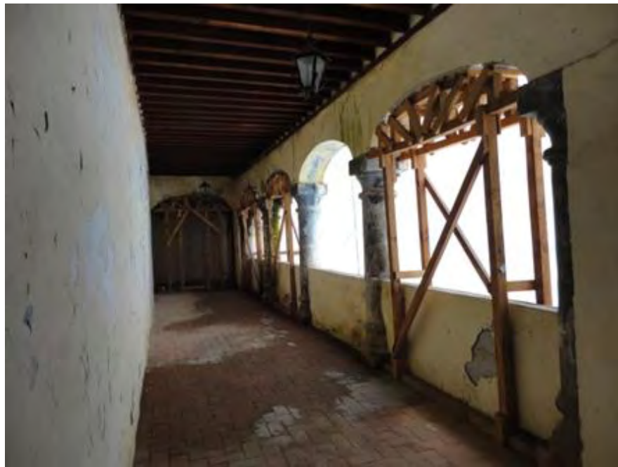
Figura 393. Tochimilco, Puebla. Ex convento Nuestra Señora de la Asunción. Claustro alto, deambulatorio. Trabajos de intervención: apuntalamiento y cimbrado para contener daño en arcos.. TMH 2018
