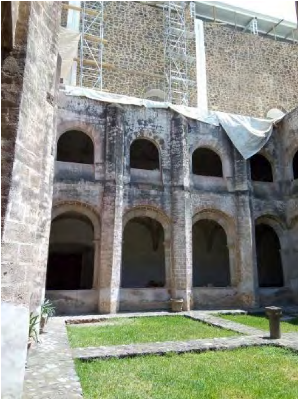
Figura 317. Tlayacapan, Mor. Ex convento San Juan Bautista. Claustro. Trabajos de intervención. TMH 2019
