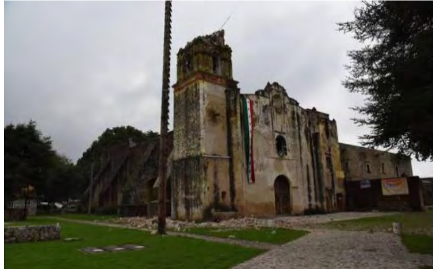
Figura 363. Tetela del Volcán, Mor. Ex convento San Juan Bautista. Fachada principal del conjunto conventual, fachada norte con contrafuertes del templo. Daños: Colapso de segundo cuerpo de torre campanario. Consulta octubre del 2019 https://www.launion.com.mx/morelos/cuautla/noticias/113463-devastados-monumentos-de-la-ruta-de-los-conventos.html
