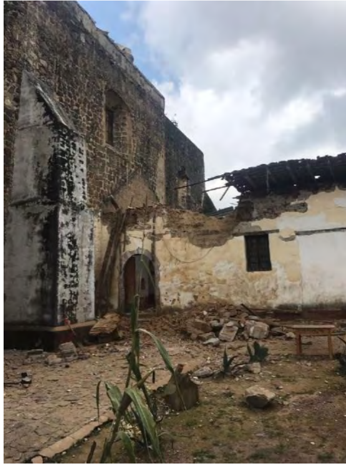
Figura 372. Hueyapan, Mor. Ex convento Santo Domingo de Guzmán. Conjunto conventual. Colapso de muros y derrumbe de cubierta. Consulta agosto del 2019 https://www.launion.com.mx/morelos/cuautla/noticias/113463-devastados-monumentos-de-la-ruta-de-los-conventos.html
