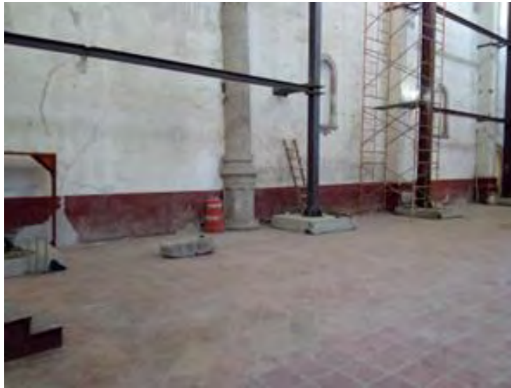
Figura 310. Tlayacapan, Mor. Ex convento San Juan Bautista. Interior del templo. Estructura de acero que se integró como protección en caso de colapso, apoyada en dados sobrepuestos de concreto. TMH 2019
