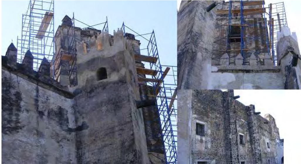
Figura 343. Yecapixtla, Mor. Ex convento San Juan Bautista. Templo, exterior. Trabajos de Intervención en muros, almenas.Consolidación e integración de aplanados a la cal. Consulta 26 de noviembre del 2019 https://www.elsoldecuernavaca.com.mx/local/estara-listo-san-juan-en-10-meses-1927290.html
