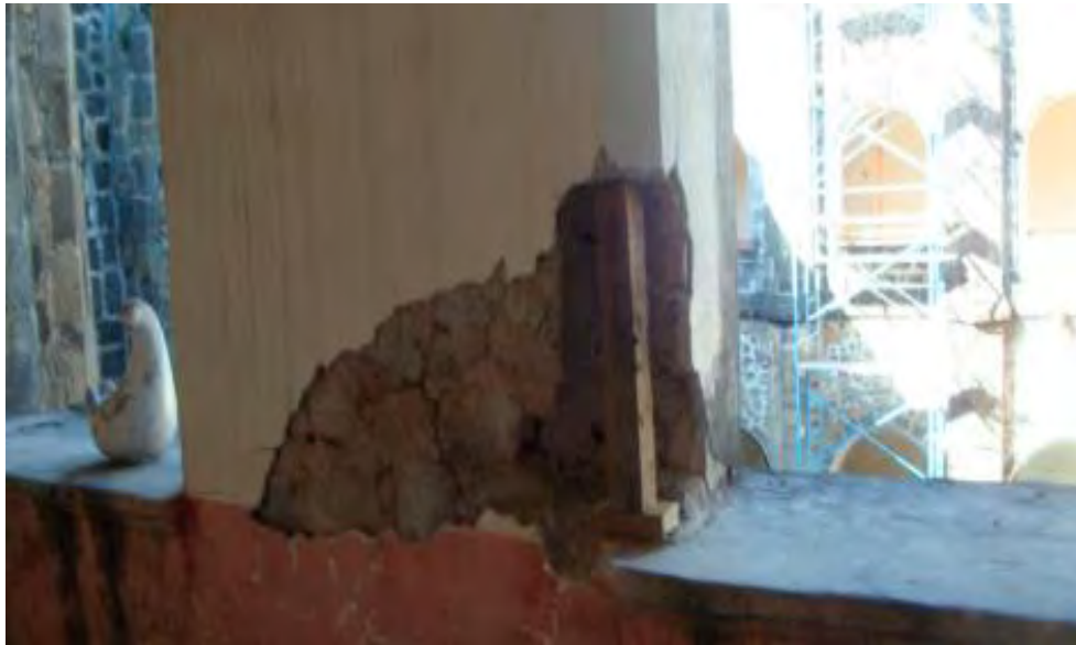
Figura 367. Tetela del Volcán, Mor. Ex convento San Juan Bautista. Convento. Deambulatorio en claustro alto. Daños: Desprendimiento de aplanados con pintura mural. Consultado el 28 de octubre del 2019 https://www.lajornadamorelos.com.mx/municipios/2019/08/30/13516
