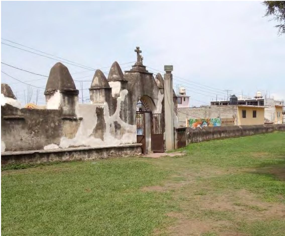
Figura 320. Atlatlahucan, Mor. Ex convento San Mateo Apóstol. Arco de accesos al atrio. Se muestran trabajos de consolidación de materiales en muro y almenas de barda. TMH 2019
