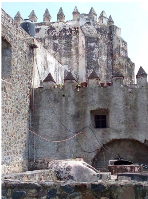
Figura 242. Atlatlahucan, Mor. Ex convento San Mateo Apóstol. Fachada oriente del conjunto conventual. Coronamiento de muros con almenas en ábside. TMH junio 2019
