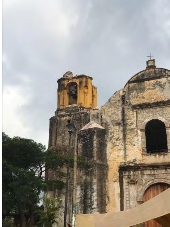
Figura 359. Ocuiluco, Mor. Ex convento Santiago Apóstol. Colapso del segundo cuerpo de torre campanario durante el sismo del 19 de septiembre del 2017. Consulta 16 octubre 2019 https://www.launion.com.mx/morelos/cuautla/noticias/113463-devastados-monumentos-de-la-ruta-de-los-conventos.html
