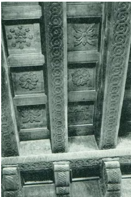
Figura 187. Tetela del Volcán, Mor. Vigas y tableros del techo de la sacristía. Martínez Marín, 1968, lam. 12 y 13
