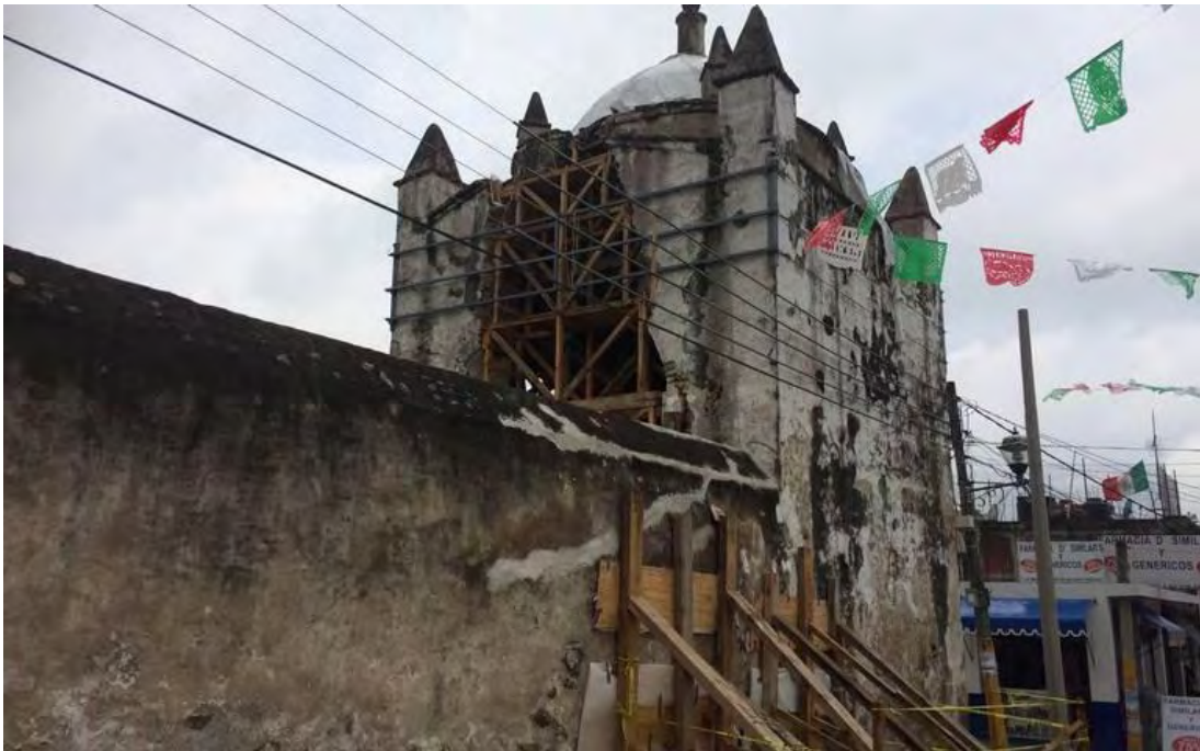
Figura 327. Atlalahucan, Morelos. Ex convento San Mateo Apóstol. Capilla posa. Proceso de trabajos de intervención: apuntalamiento de muros, cúpula y barda atrial. Consulta marzo del 2019 https://www.lajornadamorelos.com.mx/sociedad-y-justicia/2019/09/19/14063
