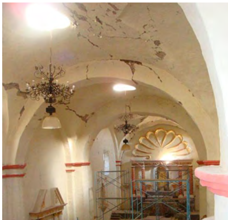
Figura 366. Tetela del Volcán, Mor. Ex convento San Juan Bautista. Interior del templo, vista hacia presbiterio. Daños: grietas en muros y bóveda, desprendimiento de recubrimientos y colapso de arcos y bóvedas. Consultl 28 de octubre del 2019 https://www.lajornadamorelos.com.mx/municipios/2019/08/30/13516
