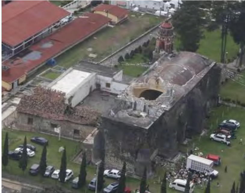
Figura 370. Hueyapan, Mor. Ex convento Santo Domingo de Guzmán. Colapso de cúpula en templo y derrumbe de cubierta en edificio conventual. Consultado el 18 de agosto 2019 https://www.jornada.com.mx/2018/01/30/politica/015n1pol
