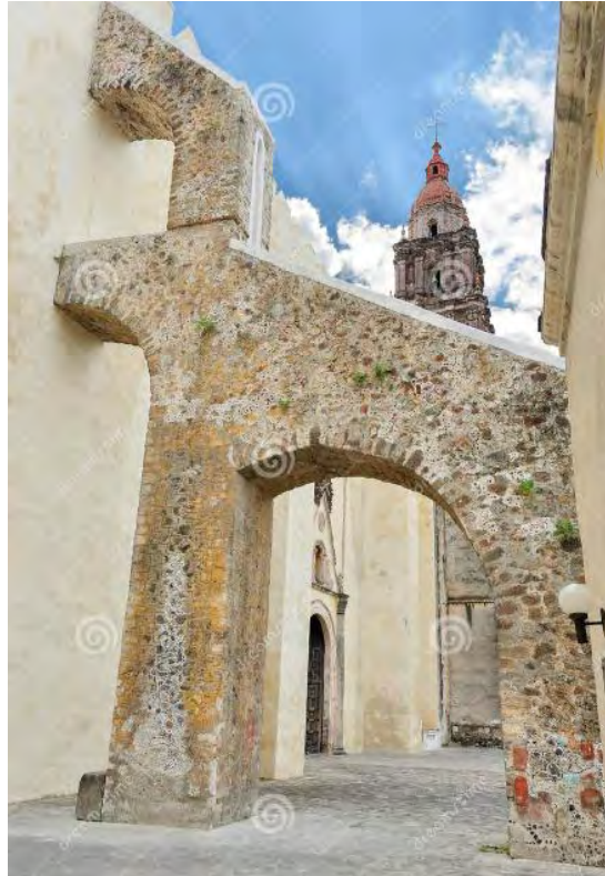
Figura 272. Cuernavaca, Mor. Ex convento La Asunción, hoy catedral. Contrafuerte, muro del evangelio. Muros exteriores con acabado encalado. Consulta 20 de noviembre del 2019 https://www.google.com/search?q=catedral+de+cuernavaca+restauracion&tbm=isch&ved=2ahUK
