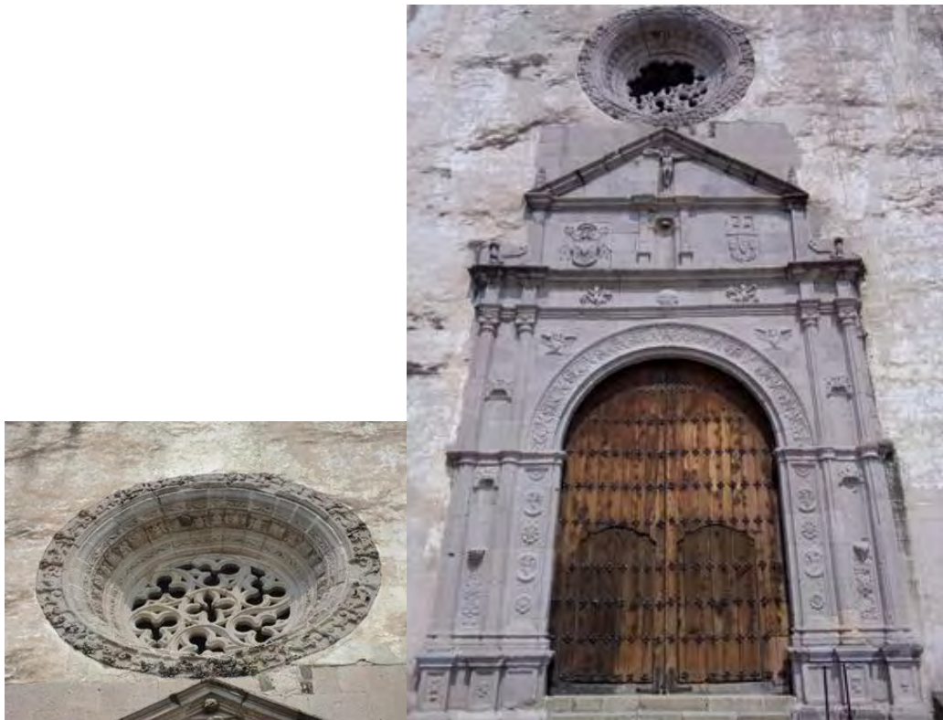
Figuras 341 y 342. Yecapixtla, Mor. Ex convento San Juan Bautista. Portada. Colapso de rosetón. Antes (TMH junio del 2017) y después del sismo del 19 de septiembre del 2019 (TMH junio del 2019).
