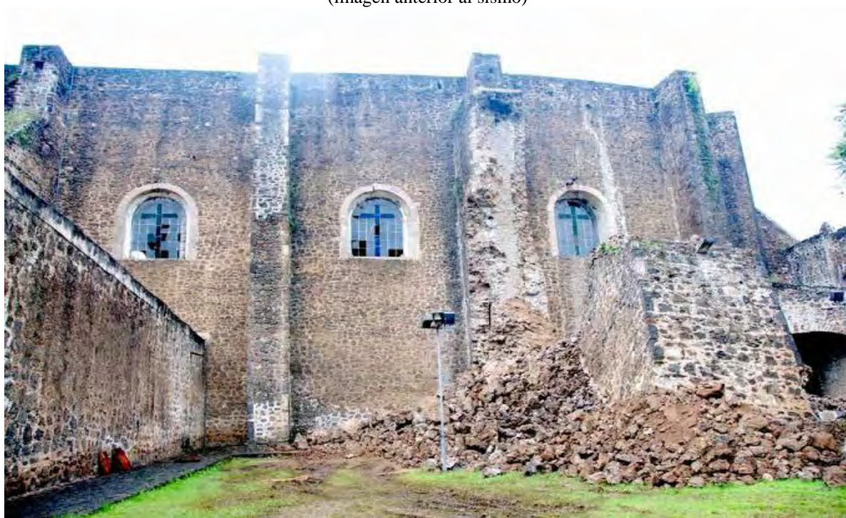
Figura 305. Tlayacapan, Mor. Ex convento San Juan Bautista. Muro y contrafuerte de la epístola. Colapso de contrafuerte. Consulta 20 de noviembre del 2019 https://www.conexion58.com/2017/10/evaluaran-danos-al-patrimonio-mundial-en-el-estado-de-morelos/
