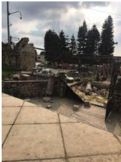
Figura 360. Ocuiluco, Mor. Ex convento Santiago Apóstol. Colapso de barda atrial y arcada real. Consulta octubre 2019 https://www.launion.com.mx/morelos/cuautla/noticias/113463-devastados-monumentos-de-la-ruta-de-los-conventos.html
