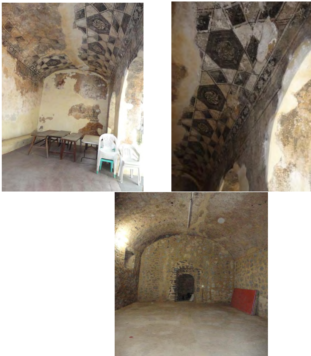
Figura 232. Tlayacapan, Mor. Ex convento San Juan Bautista. Trabajos de consolidación de materiales. Ubicada en espacios en la zona oriente, junto a la colindancia. TMH 2010
