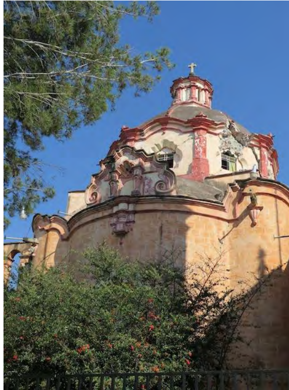
Figura 382. Zacualpan de Amilpas, Mor. Ex convento de la Inmaculada Concepción. Daños en la cúpula: fracturas y desprendimiento de materiales. Consulta 28 de noviembre del 2019 https://restauracionpatrimonio.cultura.gob.mx/multimedia/detalle/214
