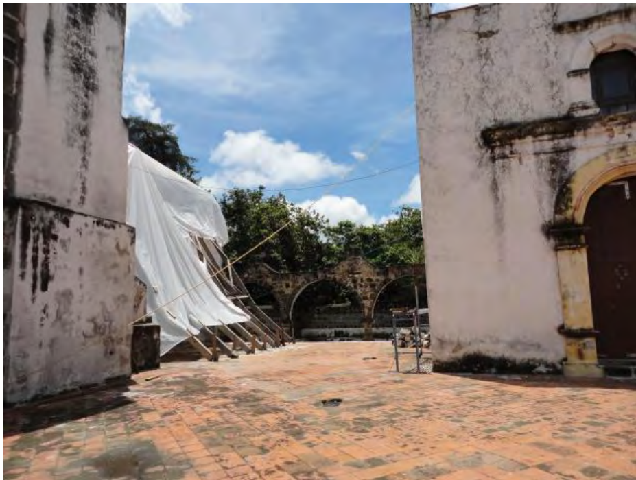
Figura 395. Tochimilco, Puebla. Ex convento Nuestra Señora de la Asunción. Aljibe al fondo. Apuntalamiento de muros. TMH 2018
