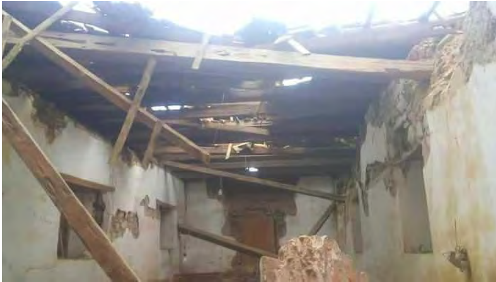
Figura 374. Hueyapan, Mor. Ex convento Santo Domingo de Guzmán. Interior del ex convento Colapso de cubierta de estructura de madera a dos aguas y teja. Derrumbe de muro y desprendimiento de aplanados. Consulta agosto del 2019 https://superluchas.com/sismo-en-morelos-reflexion-sobre-el-patrimonio-historico-perdido/
