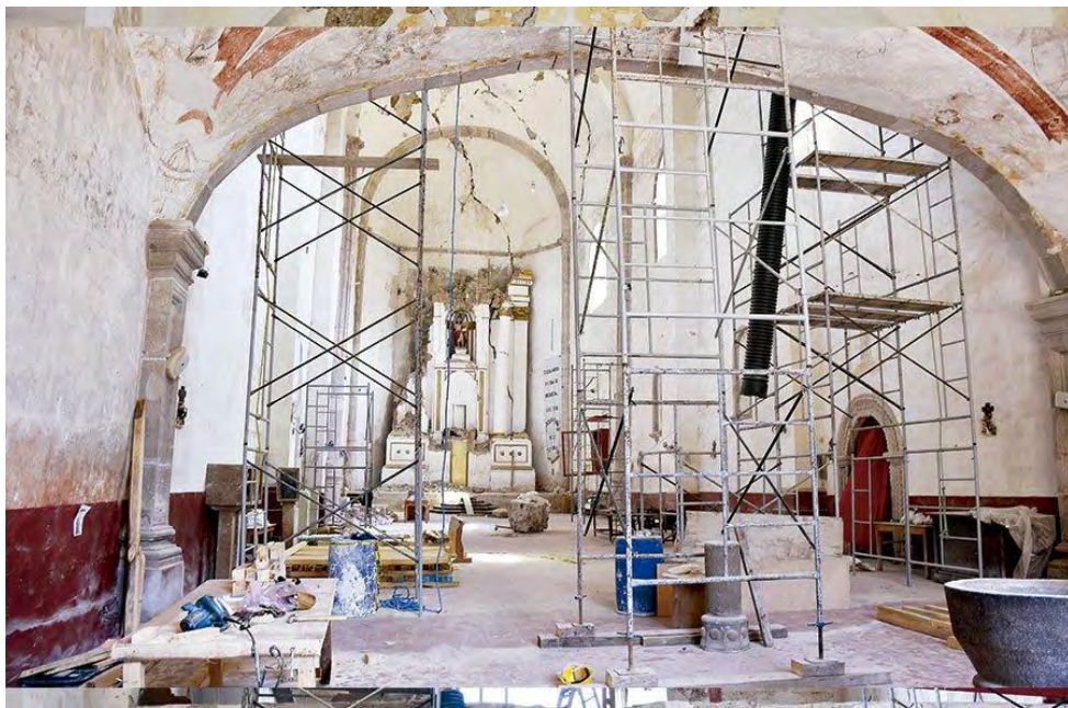
Figura 303. Tlayacapan, Mor. Ex convento San Juan Bautista. Templo. Interior. Coro. Daños en la bóveda de cañón corrido que cubre la nave. Daños: grieta a lo largo de la nave y muro del coro, desprendimiento de material. Consulta junio del 2019 https://interactivo.eluniversal.com.mx/2019/patrimonio-sismos
