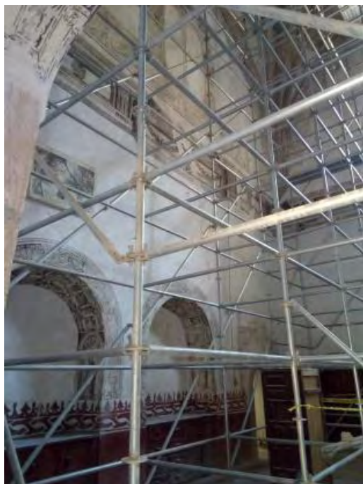
Figura 312. Tlayacapan, Mor. Ex convento San Juan Bautista. Sacristía. Trabajos de intervención, la cubierta presentó fracturas. TMH 2019
