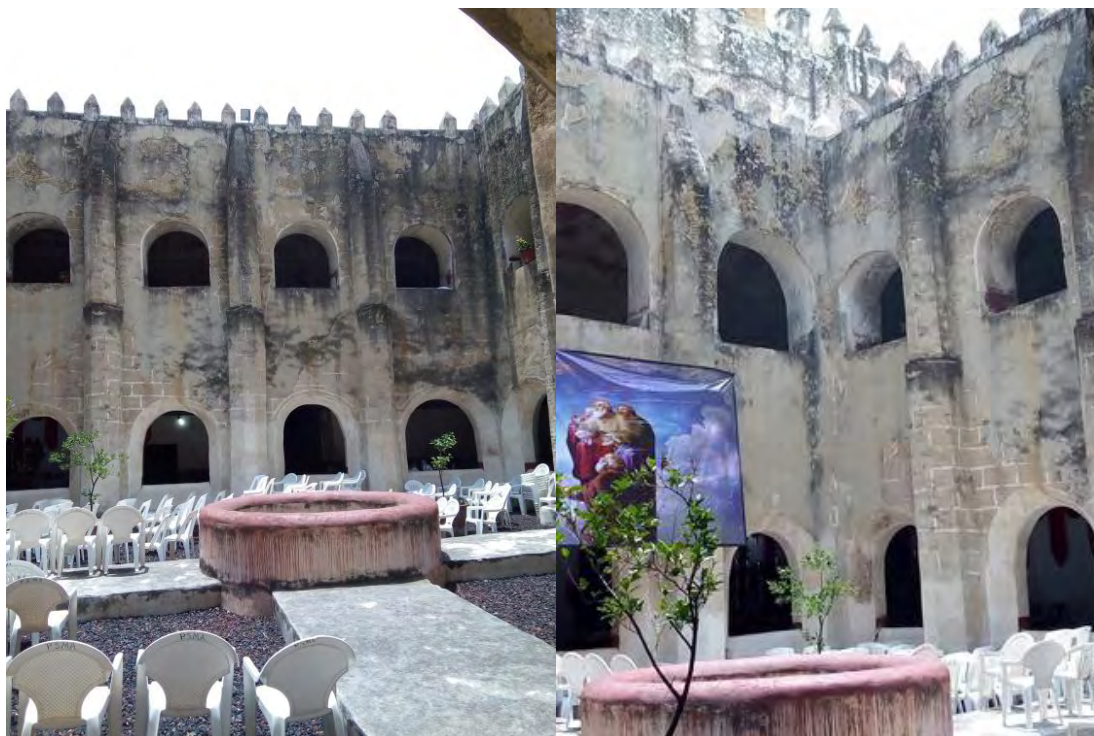
Figuras 329 y 330. Atlalahucan, Mor. Ex convento San Mateo Apóstol. Claustro. Patio. El uso está destinado a las actividades del templo durante los trabajos de rehabilitación. TMH 2019
