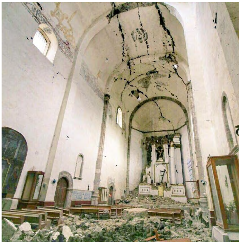
Figura 300. Tlayacapan, Mor. Ex convento San Juan Bautista. Templo. Interior. Daños en la bóveda de cañón corrido que cubre la nave. Daños: grieta a lo largo de la nave y el presbiterio. Colapso de altar en el ábside. Consulta 6 de julio del 2019 https://www.eluniversal.com.mx/especiales/cultura/2017/09/28/1005252/nota/1005625/0/destruccion-en-la-ruta-de-los-conventos
