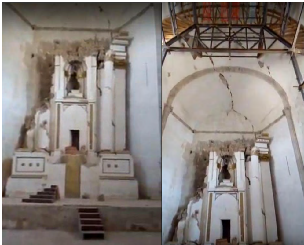
Figura 311. Tlayacapan, Mor. Ex convento San Juan Bautista. Interior del templo. Estado de conservación de la estructura del altar mayor, se liberó el material desprendido. Estructura de acero que se integró como protección en caso de colapso. TMH 2019
