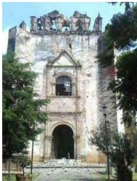
Figura 298. Tlayacapan, Mor. Ex convento San Juan Bautista. Templo, fachada. Daños producidos por el sismo del 19 de septiembre del 2017: grieta vertical en muro de portada, daño en sotocoro, coro y espadaña.
