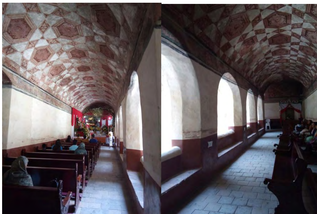
Figuras 332 y 333. Atlalahucan, Mor. Ex convento San Mateo Apóstol. Claustro. Deambulatorio. El uso está destinado a las actividades religiosas, durante el proceso de trabajos de rehabilitación en la cubierta del templo. TMH 2019
