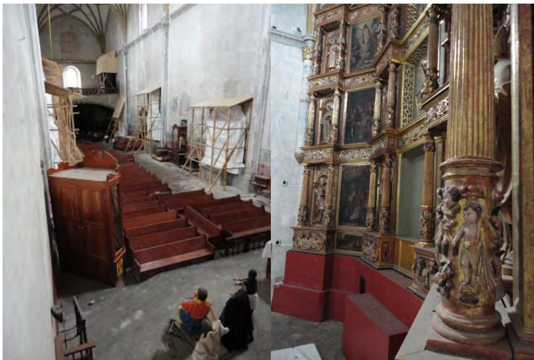
Figura 407. Huejotzingo, Pue. Ex convento San Miguel Arcángel. Interior del templo. Nave y presbiterio. Los muros y bóvedas presentan fracturas. En espera de trabajos de intervención. TMH 2018
