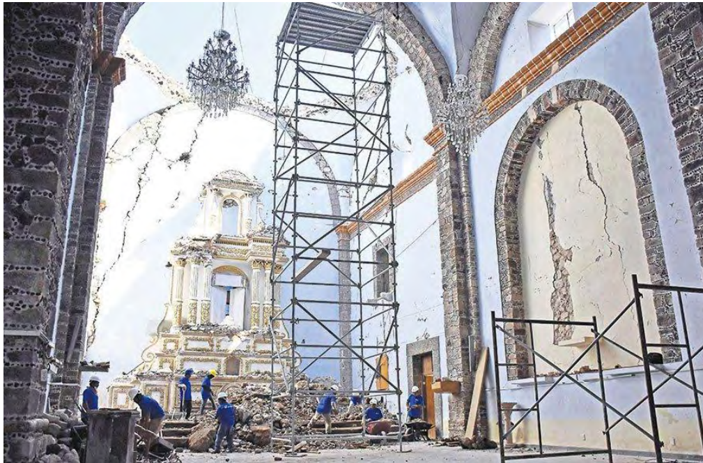
Figura 292. Totolapan, Mor. Ex convento San Guillermo. Interior del templo. Daños: Colapso de cúpula, agrietamientos en muros y desprendimientos de acabados al templo. Consulta 20 de noviembre del 2019 https://www.lajornadamorelos.com.mx/municipios/2019/09/18/14061?page=1
