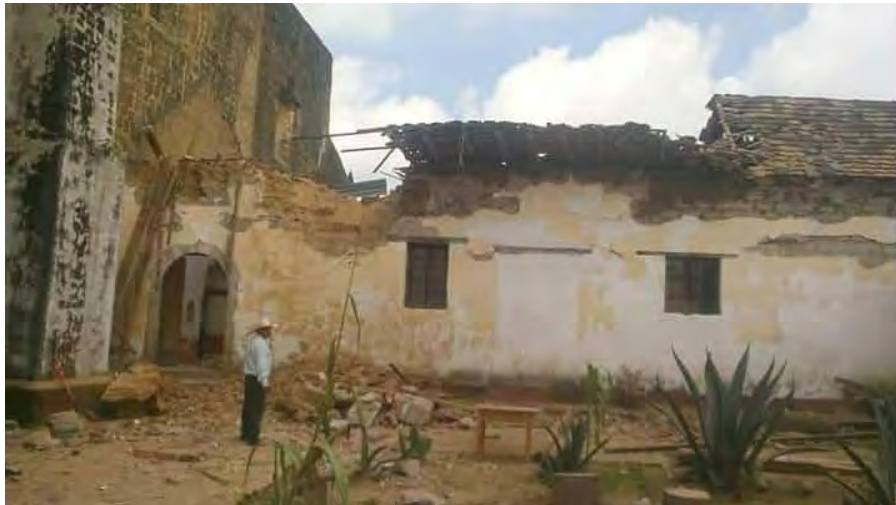
Figura 373. Hueyapan, Mor. Ex convento Santo Domingo de Guzmán. Vista desde patio del convento. Colapso de cubierta de estructura de madera a dos aguas y teja. Derrumbe de muro y desprendimiento de aplanados. Consultado en agosto del 2019 https://superluchas.com/sismo-en-morelos-reflexion-sobre-el-patrimonio-historico-perdido/
