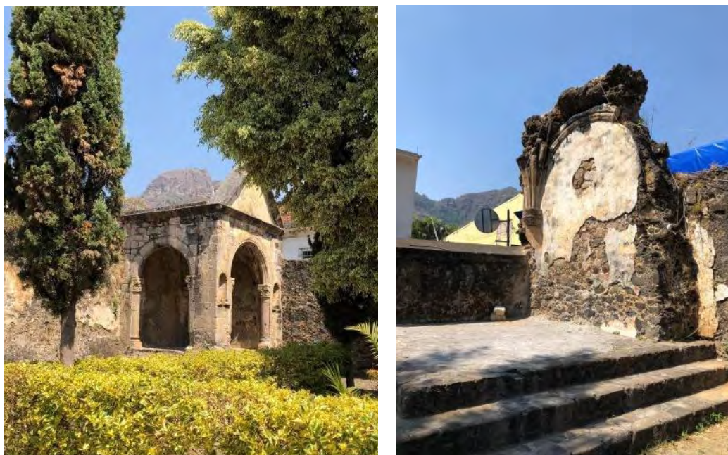
Figura 215. Tepoztlán, Mor. Ex convento Nuestra Señora de La Natividad. Capillas posa, estado de conservación. TMH 2019
