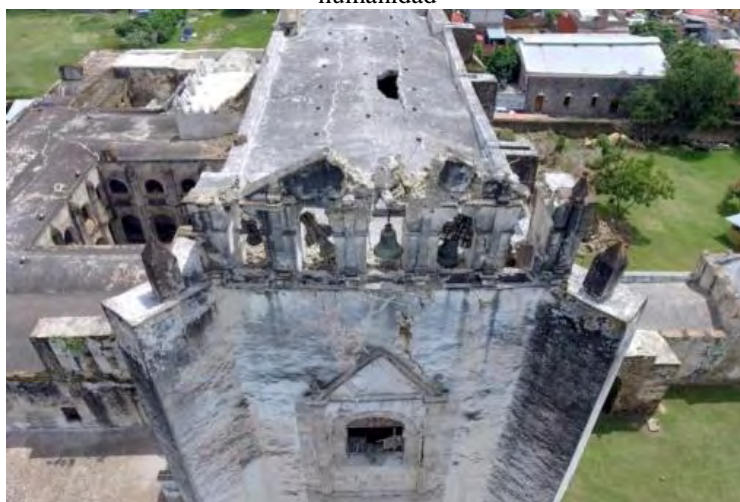
Figura 299. Tlayacapan, Mor. Ex convento San Juan Bautista. Templo. Espadaña y bóveda de cañón corrido. Colapso de bóveda, grieta a lo largo de la nave; espadaña con pérdida de material, estructura dañada. Consulta 12 nov 2019 https://www.proceso.com.mx/504221/sismo-arraso-templo-san-juan-bautista-tlayacapan-considerado-patrimonio-la-humanidad
