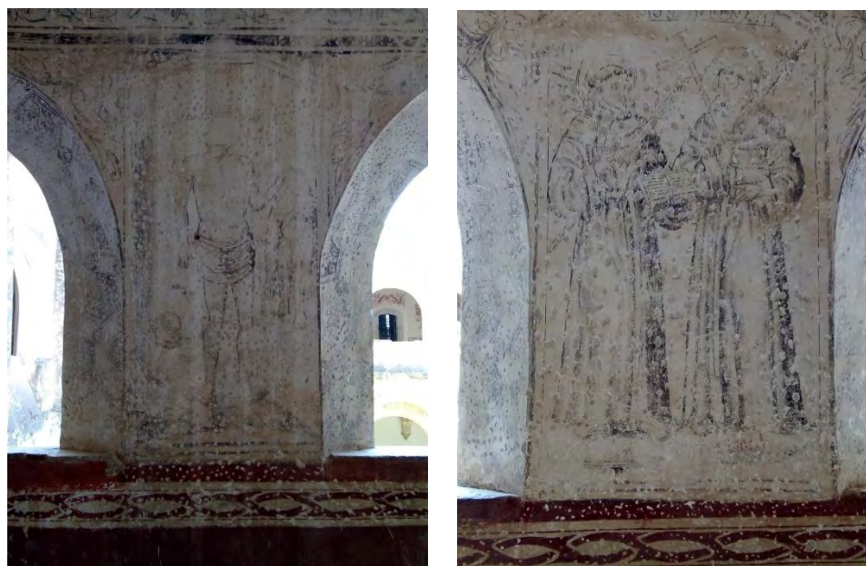
Figuras 235. Tlayacapan, Mor. Ex convento San Juan Bautista. Claustro alto. Deambulatorio. Daños en aplanado y pintura mural. TMH 2019
