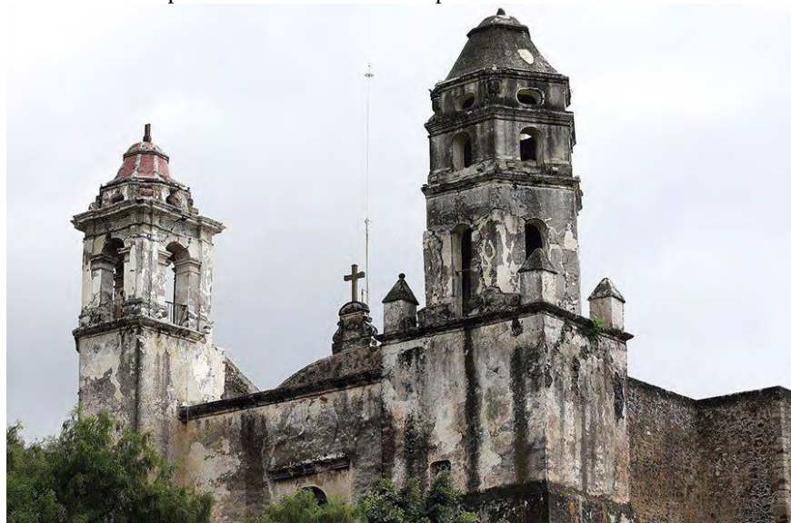
Figura 281. Tepoztlán, Mor. Ex convento Nuestra Señora de La Natividad. Campanarios. Daños: grietas, desprendimiento de material en molduras, aplanados y pintura. TMH 2019
