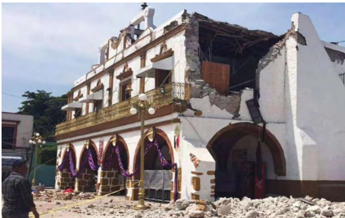
Figura 266. Jojutla de Juárez, Morelos. Efectos del sismo y daños severos en muchas de las construcciones. Consultado el 6 de diciembre del 2019 https://www.economista.com.mx/politica/En-Jojutla-donde-el-sismo-sensano-mas-con-Mexico-20170919-0044.html
