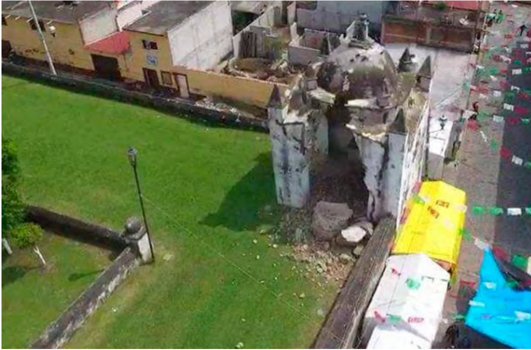
Figura 326. Atlalahucan, Morelos. Ex convento San Mateo Apóstol. Capilla posa. Daño: colapso de muro y agrietamiento de cúpula. Consulta marzo del 2019 https://www.lajornadamorelos.com.mx/sociedad-y-justicia/2019/09/19/14063
