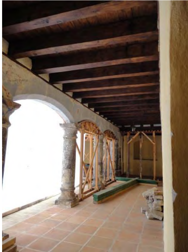
Figura 390. Tochimilco, Puebla. Ex convento Nuestra Señora de la Asunción. Claustro bajo. Deambulatorio. Daños: Fracturas en arcos. Proceso de intervención: apuntalamiento de arcos. TMH 2018
