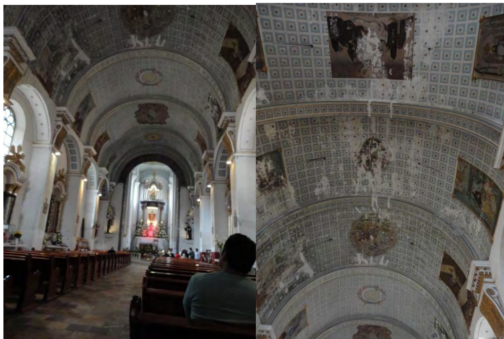
Figura 404. San Andrés Calpan, Puebla. Ex convento de San Francisco de Asís. Interior del templo. Daños en bóveda. TMH 2018
