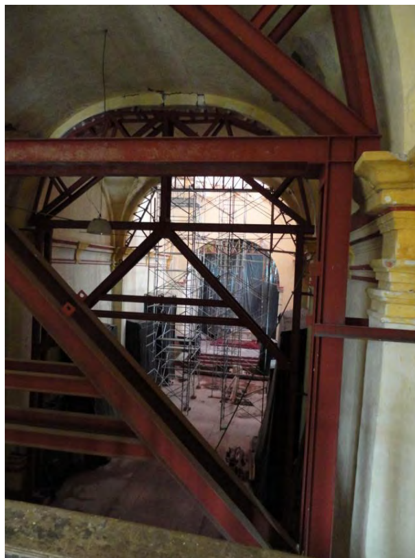
Figura 379. Hueyapan, Mor. Ex convento Santo Domingo de Guzmán. Interior templo. Colocación de estructura provisional de acero y apuntalamiento de arcos. TMH 2019
