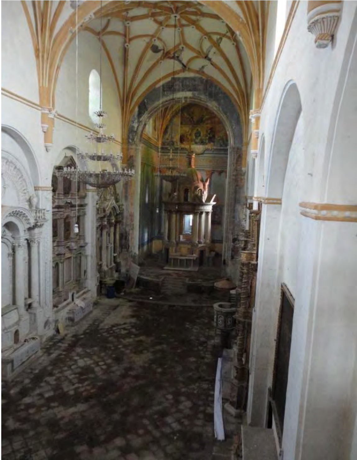
Figura 389. Tochimilco, Puebla. Ex convento Nuestra Señora de la Asunción. Interior del templo: Nave y presbiterio. Daños: fracturas en cubiertas, bóvedas y plementos. Desprendimientos de acabados. TMH 2018
