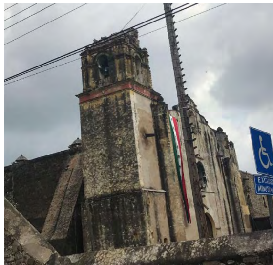
Figura 364. Tetela del Volcán, Mor. Ex convento San Juan Bautista. Fachada principal del templo, fachada norte con contrafuertes del templo. Daños: Colapso de segundo cuerpo de torre campanario. Consulta octubre del 2019 https://www.launion.com.mx/morelos/cuautla/noticias/113463-devastados-monumentos-de-la-ruta-de-los-conventos.html
