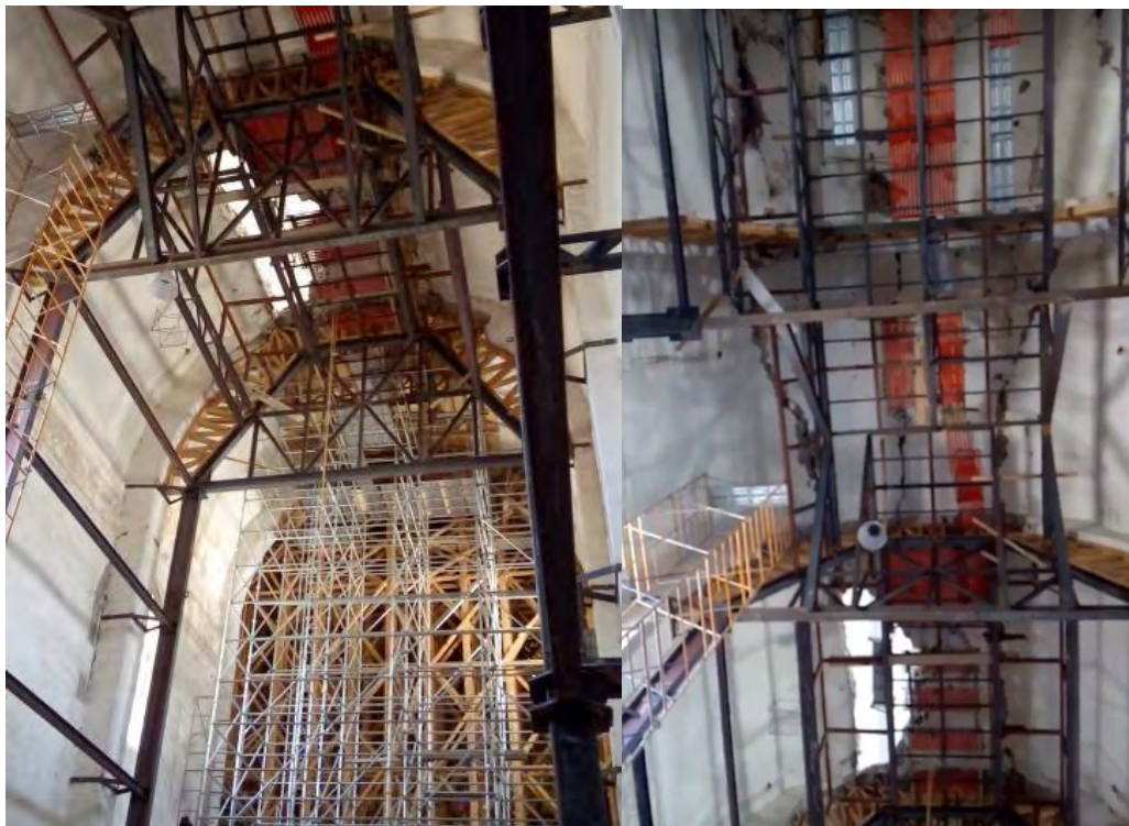
Figura 309. Tlayacapan, Mor. Ex convento San Juan Bautista. Interior del templo. Estructura de acero que se integró como protección en caso de colapso. TMH 2019
