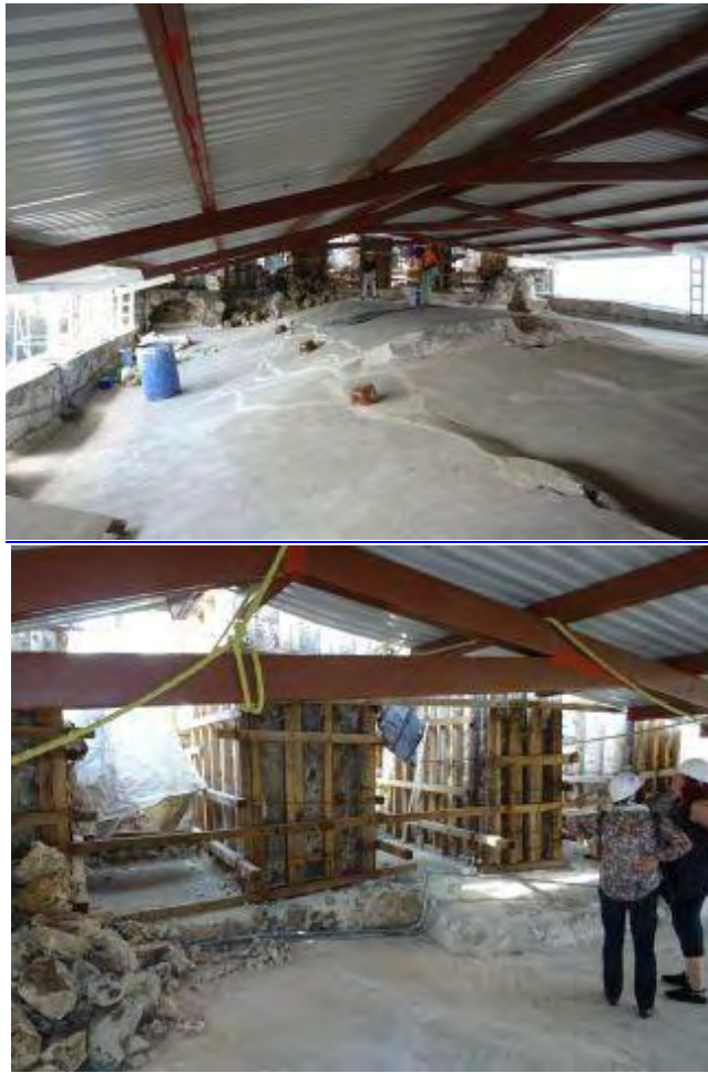
Figura 306. Tlayacapan, Mor. Ex convento San Juan Bautista. Azotea de templo. Trabajos de intervención en bóveda de cañón corrido y en espadañas. Consultado en junio del 2019 http://campaners.com/php/fotos_campanar.php?numer=9287
