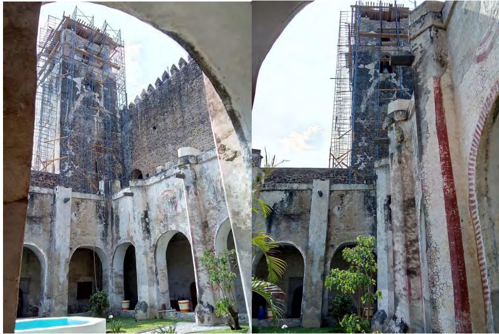
Figura 351. Yecapixtla, Mor. Ex convento San Juan Bautista. Claustro. Estado de conservación y trabajos de intervención en torre campanario. TMH 2019
