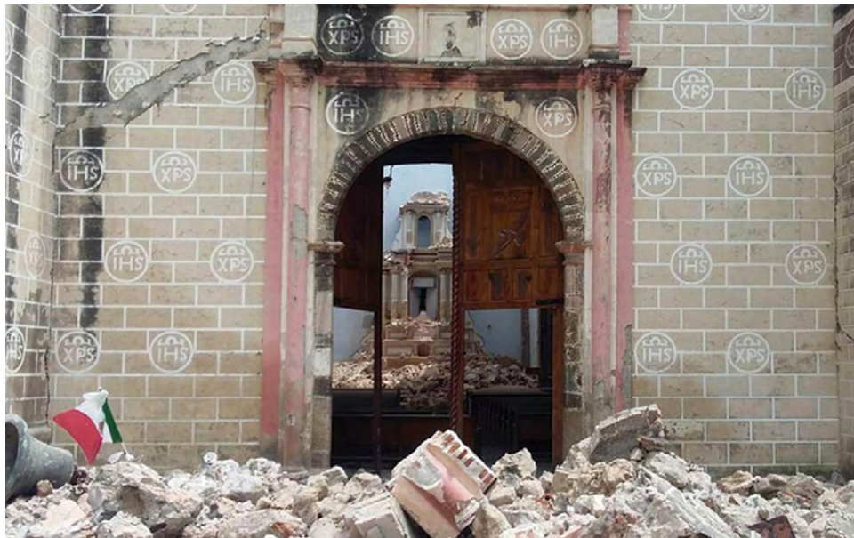
Figura 287. Totolapan, Mor. Ex convento San Guillermo. Acceso al templo. Daños ocasionados por el sismo del 19 de septiembre del 2017: colapso de elementos y aplanados de muros en exterior, colapso de cúpula, daños en bóveda de cañón, desprendimientos de aplanados. Consulta junio del 2019 https://noticias.canal22.org.mx/2018/04/30/avances-en-la-restauracion-del-convento-de-san-guillermo
