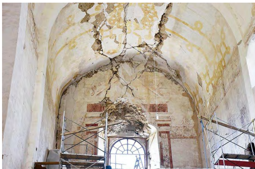
Figura 301. Tlayacapan, Mor. Ex convento San Juan Bautista. Templo. Interior. Coro. Daños en la bóveda de cañón corrido que cubre la nave. Daños: grieta a lo largo de la nave y muro del coro, desprendimiento de material. Consulta 23 de noviembre del 2019 https://interactivo.eluniversal.com.mx/2019/patrimonio-sismos
