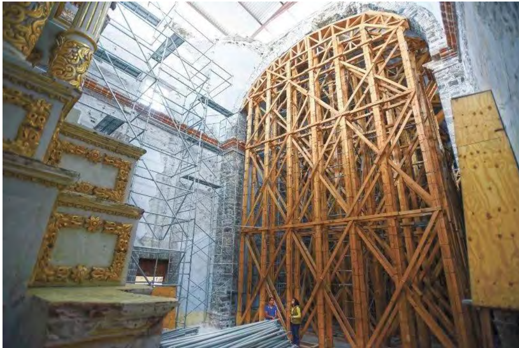
Figura 293. Totolapan, Mor. Ex convento San Guillermo. Interior del templo. Proceso de intervención. Consulta 26 de noviembre del 2019
