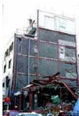
a) Colapso de un edificio de acero (NISEE, 2014)
