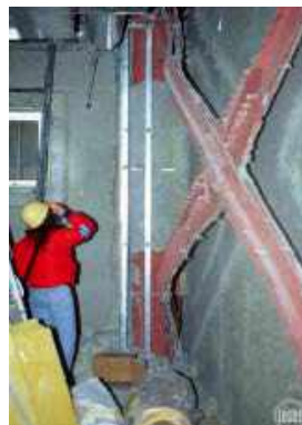
b) Pandeo de un contraviento (NISEE, 2014)
