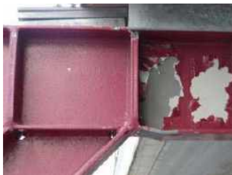
a) Daños ocurridos por la fluencia de la viga enlace (adaptada de Clifton et al. , 2011)
