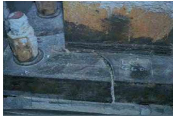
b) Fractura de una placa base de un marco con contravientos (EERI, 2014)
