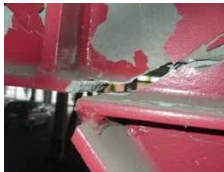
b) Daño por fractura debido a la excentricidad entre el patín del contraviento y el atiesador de la viga enlace (adaptada de Clifton et al. , 2011)
