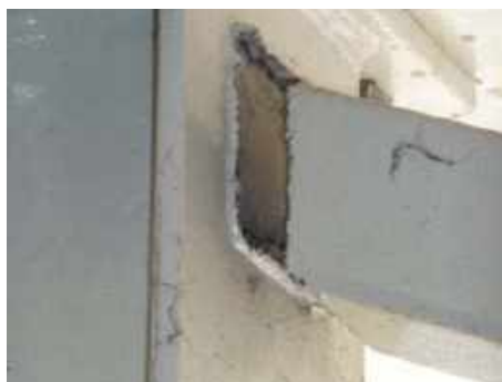
a) Fractura por tensión en la soldadura
