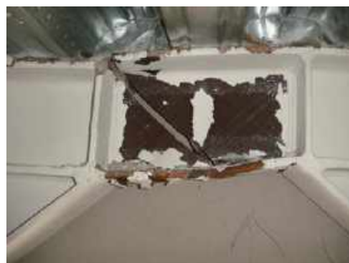
b) Fractura de la viga enlace en el nivel 6 del edificio Pacific Residential Tower (adaptada de Clifton et al. , 2011)
