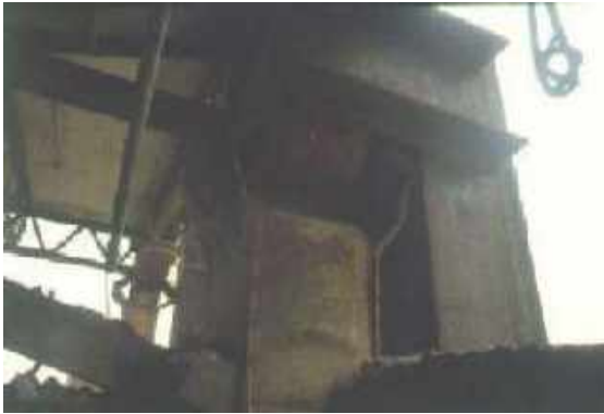
a) Pandeo local de columna exterior (adaptada de Tapia y Tena, 2001)
