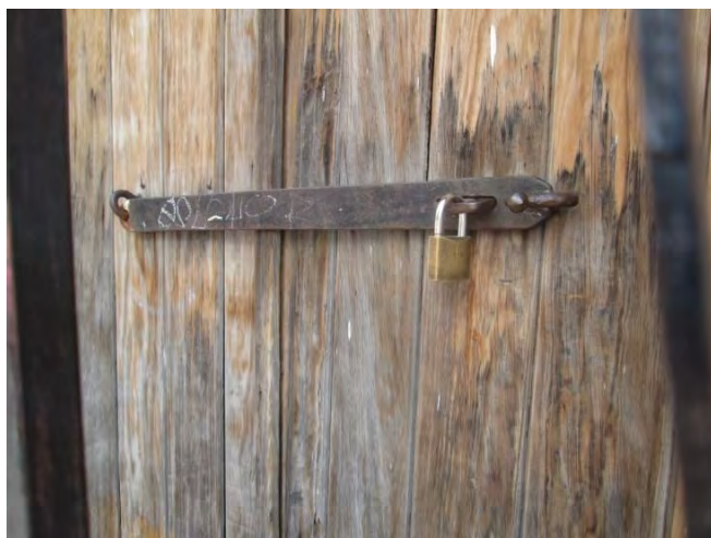
Fotografía 129. Detalle del deterioro en madera de puerta y herrajes forjados
