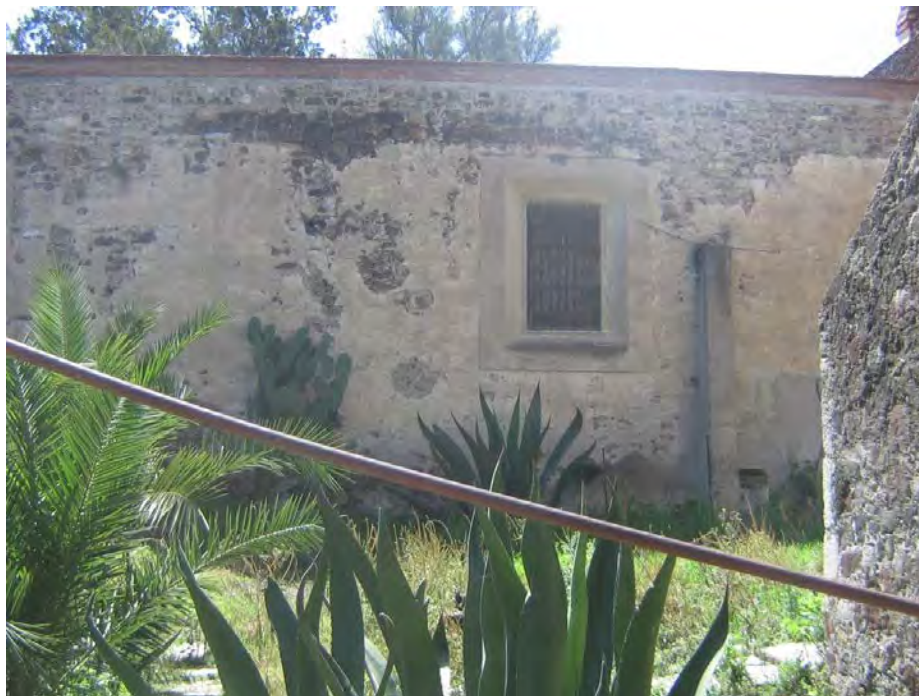
Fotografía 15. Capilla Abierta: liberación de fauna nociva, palmeras, agaves, nopales y escombros y se procederá de la siguiente manera:
