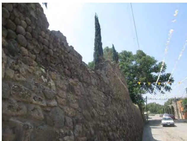
Fotografía 13. Material disgregado en muralla prehispánica, esquina San Francisco y Aztecas
