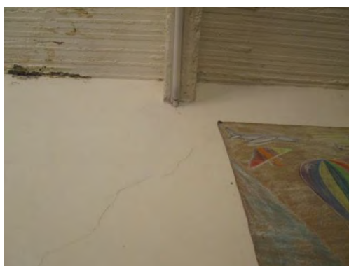
Fotografía 133. Fisuras de 1mm sobre recubrimientos: provocados por el sismo del 19/S: 2018
