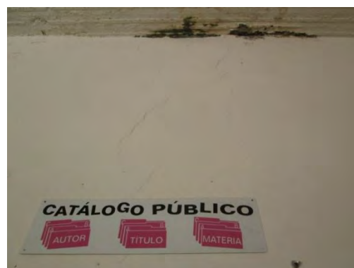
Fotografía 134. Presencia de humedad en losa de concreto armado: 2018
