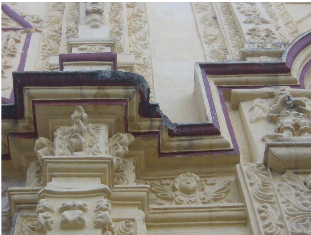
Fotografía 16. Detalle deterioro en portada Templo de San Luis Obispo: se requiere del lavado y remodelo de los elementos arquitectónicos dañados para su reintegración: previo autorización del INAH.
