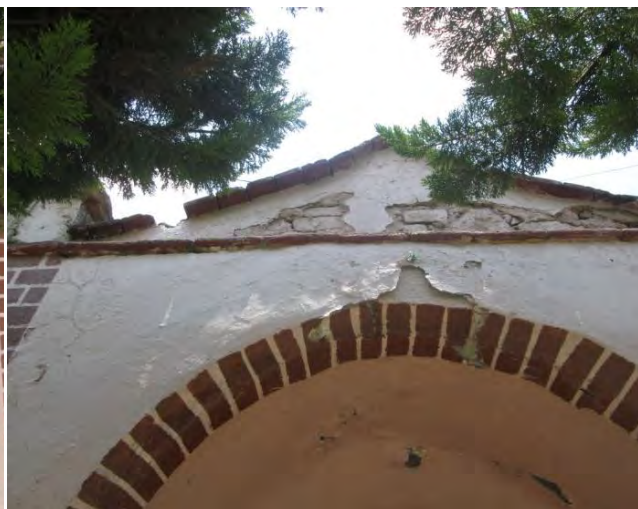
Fotografía 93. Humedad en frontón, Capilla aislada: 2018
