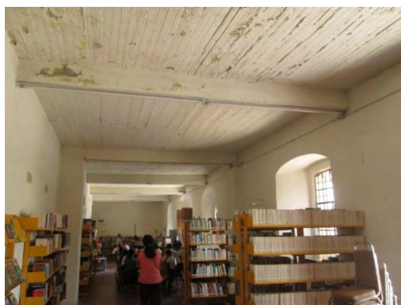
Fotografía 136. Afectación al acervo por filtración de agua: 2018
