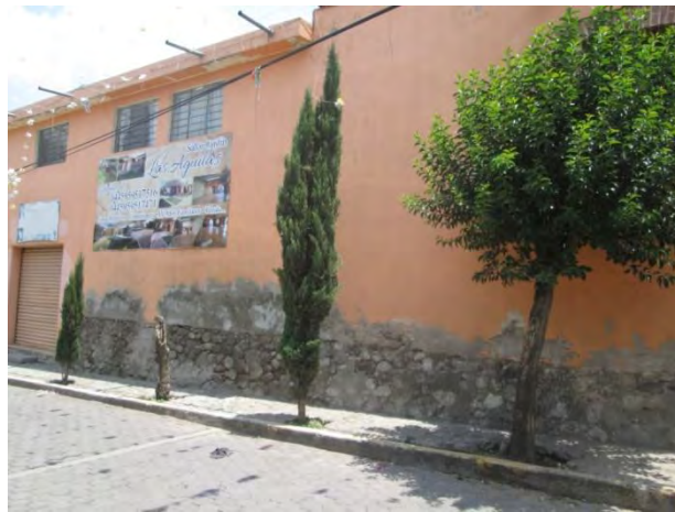
Fotografía 176. Humedades ascendentes, sobre le paramento lado sur: 2018
