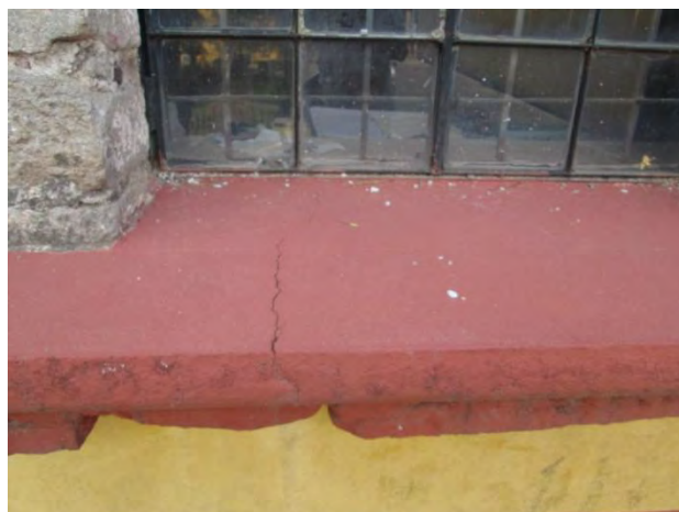
Fotografía 128. Fisura de 1 mm en peana de ventana
