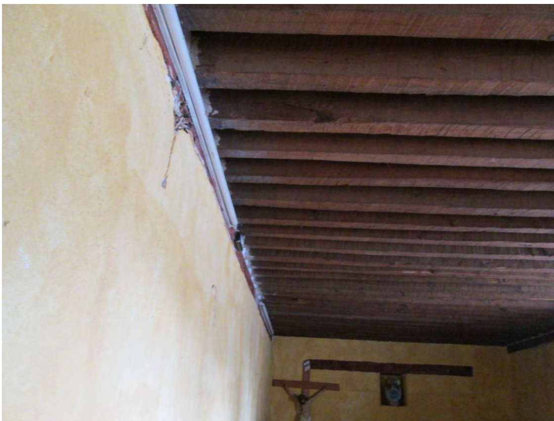
Fotografía 19. Salón del claustro bajo, se requiere de la estabilización de la madera para evitar el deterioro por resequeidad, el envigado se cambio según el archivo técnico en la década de los 80', por lo que esta en relativo buen estado.
