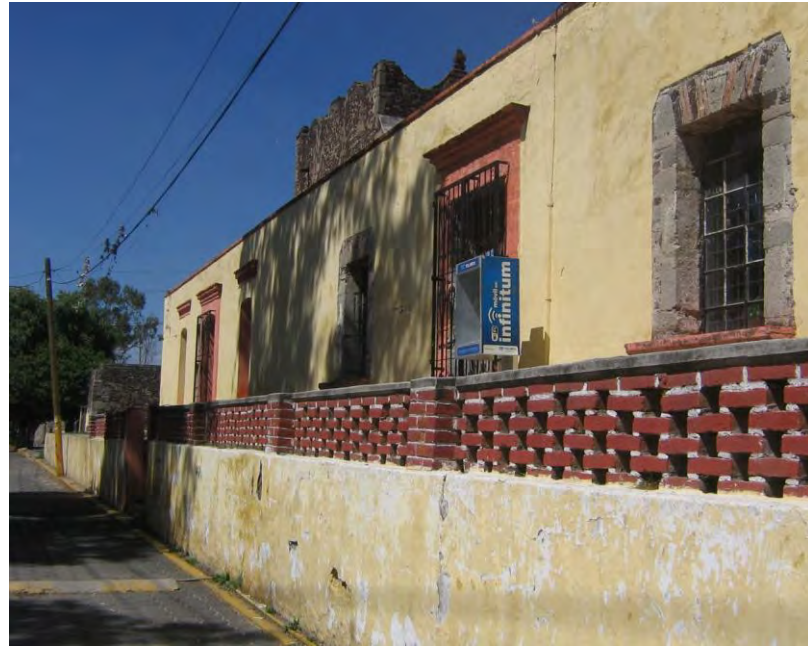
Fotografía 8. Fachada de la Biblioteca, Calle Hidalgo, se presentan manchas blancas y desprendimiento de recubrimientos en áreas focalizadas, principalmente provocadas por la aplicación de morteros con cemento y pintura plástica: OMA: 2017.
