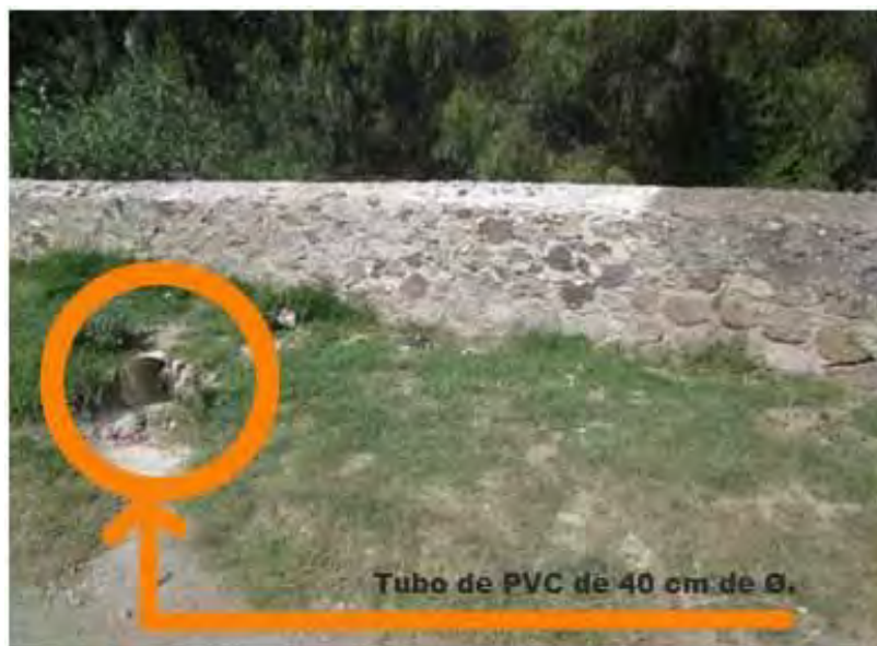
Fotografía 86. Añadido discordante, en Puente “Roto”, estructura siglo XVI
