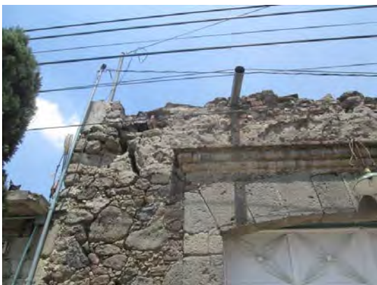
Fotografía 79. Detalle de deterioro, disgregación de material y añadido discordante
