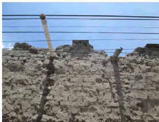
Fotografía 80. Disgregación de material, en cerramiento de la estructura original
