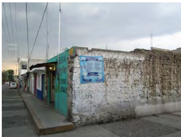
Fotografía 115. Disgregación de materiales u manchas por humedad
