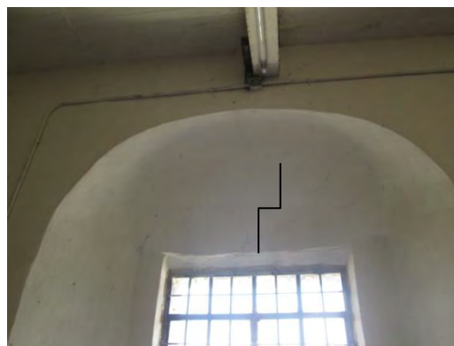
Fotografía 132. Detalle de fisura en jamba
