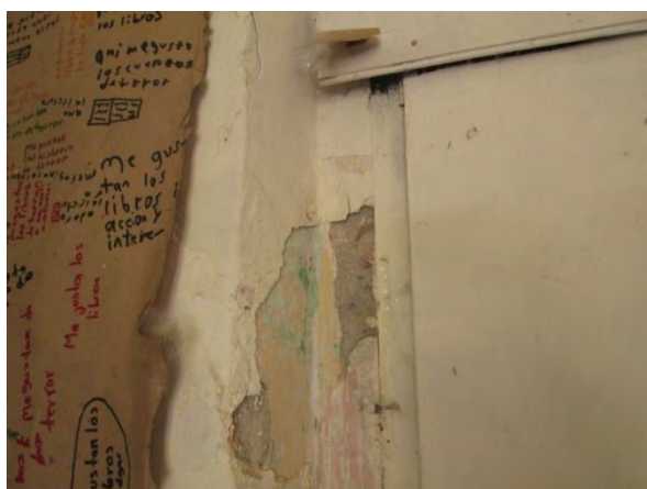
Fotografía 135. Materiales disgregados y falta de mantenimiento: 2018
