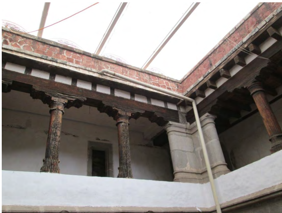
Fotografía 18. Claustro alto, añadido discordante, además se presentan desprendimiento de recubrimientos con vestigios de pintura mural, se requiere de la consolidación de los recubrimientos y la reintegración de los pigmentos y pintura mural.
