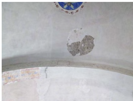
Fotografía 190. Detalle de desprendimiento de recubrimiento provocado por el sismo del 19 de Septiembre del 2017 en bóveda de arista del soto coro, San Luis Obispo
