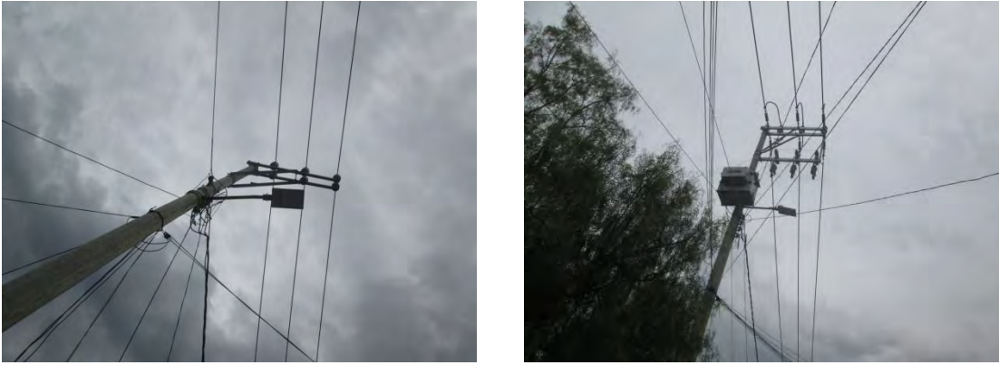
Fotografía 206. Postes de electricidad añadidos discordantes: Omar Mendoza Arias.
