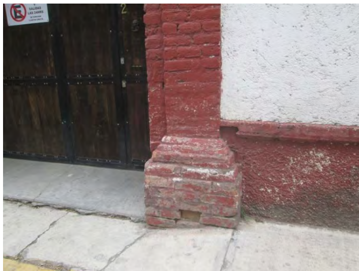
Fotografía 124. Deterioro en basamento de columna en la portada
