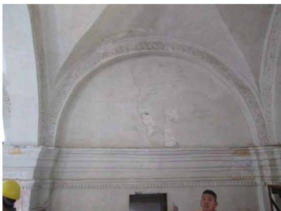
Fotografía 189. Detalle de fisura en el soto coro
