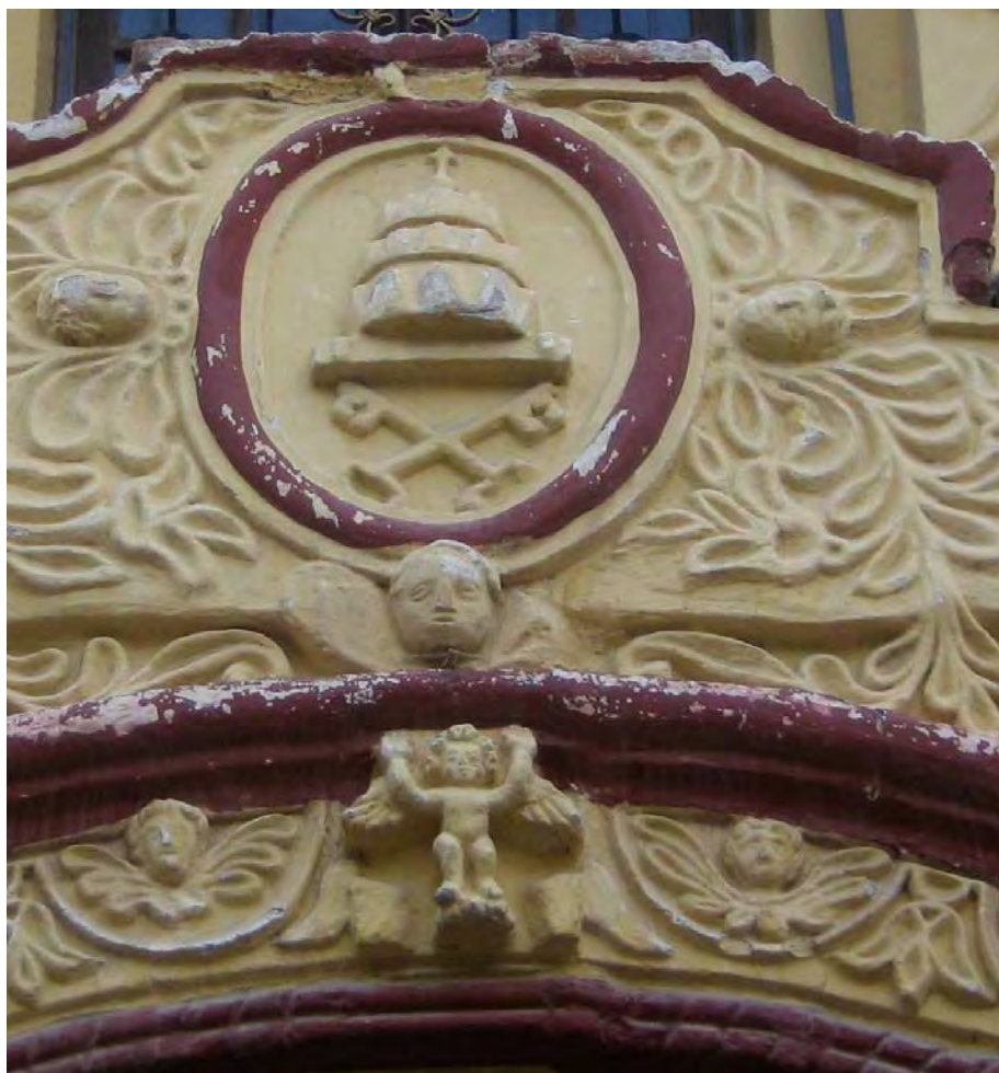
Fotografía 13. Detalle, deterioro en portada principal: Templo de San Luis Obispo: Omar Mendoza Arias
