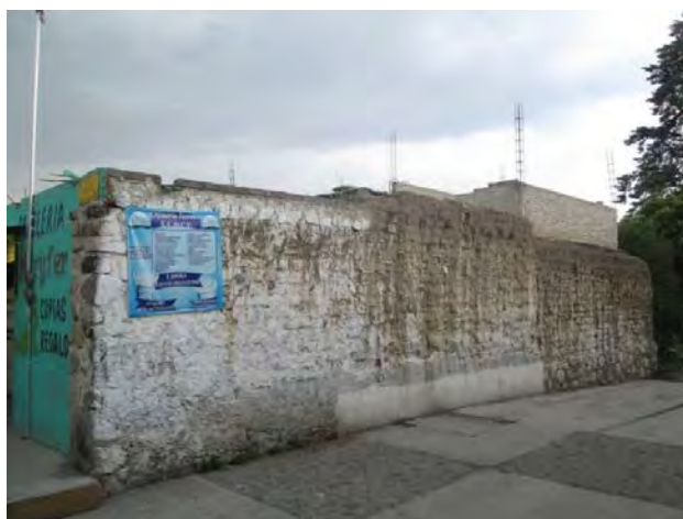
Fotografía 117. Añadidos discordantes, rótulos y estructuras adosadas
