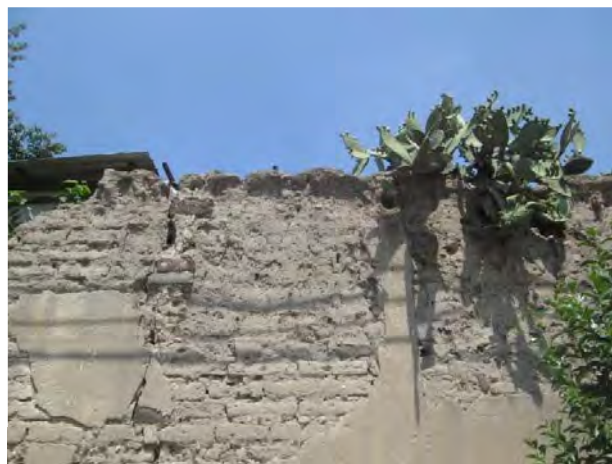
Fotografía 76. Vegetación invasiva sobre muro de adobe
