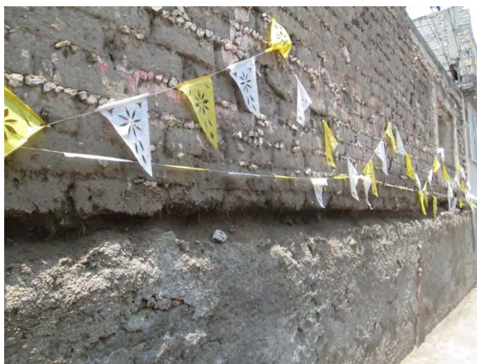
Fotografía 49. Detalle de disgregación en material: 2018
