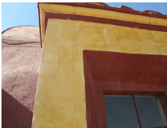
Fotografía 183. Fisuras en recubrimientos y bocinas de jambas en vanos de la cúpula del transepto
