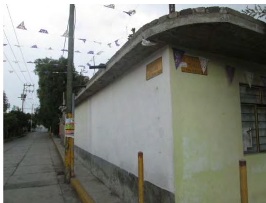
Fotografía 146. Se presentan recubrimientos de concreto y humedades ascendentes: 2018
