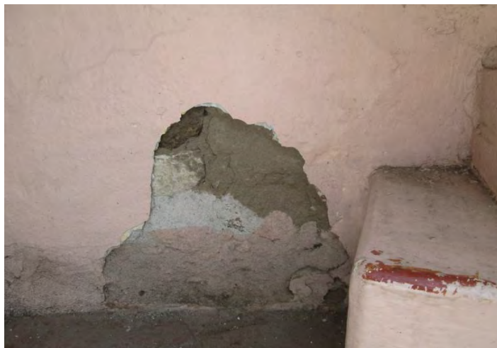
Fotografía 94. Detalle de disgregación de recubrimientos, Capilla aislada
