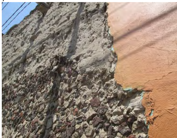
Fotografía 89. Recubrimientos de concreto
