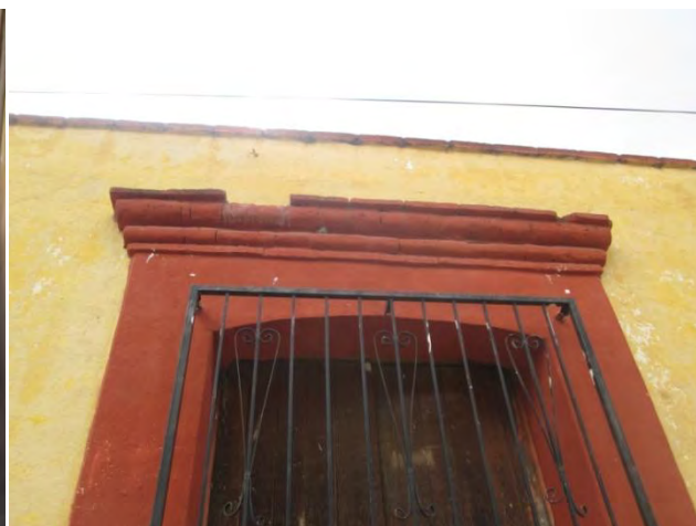
Fotografía 130. Pieza faltante en puerta de acceso
