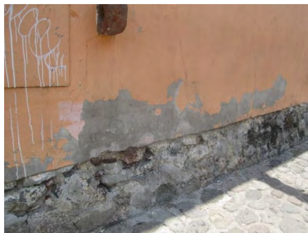
Fotografía 178. Detalle de humedades ascendentes: 2018
