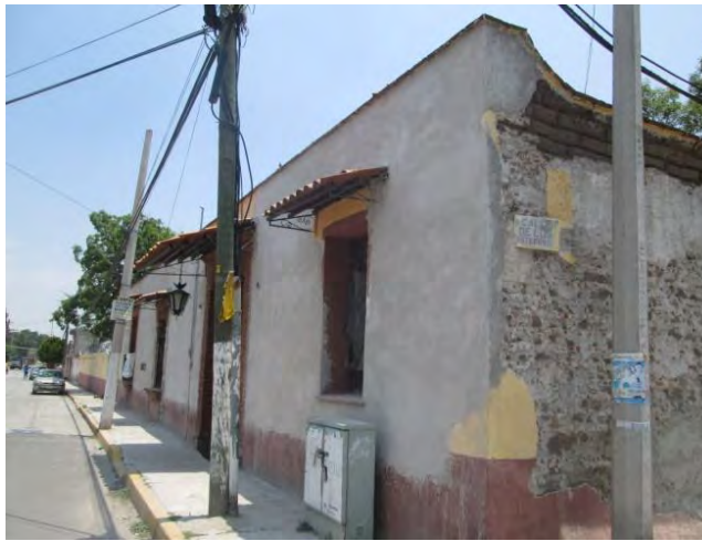
Fotografía 29. Añadido discordante en recubrimientos de concreto.
