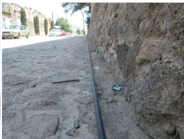
Fotografía 14. Añadido discordante, tubo de PVC para suministrar agua a las casas que están junto al puente del siglo XVI
