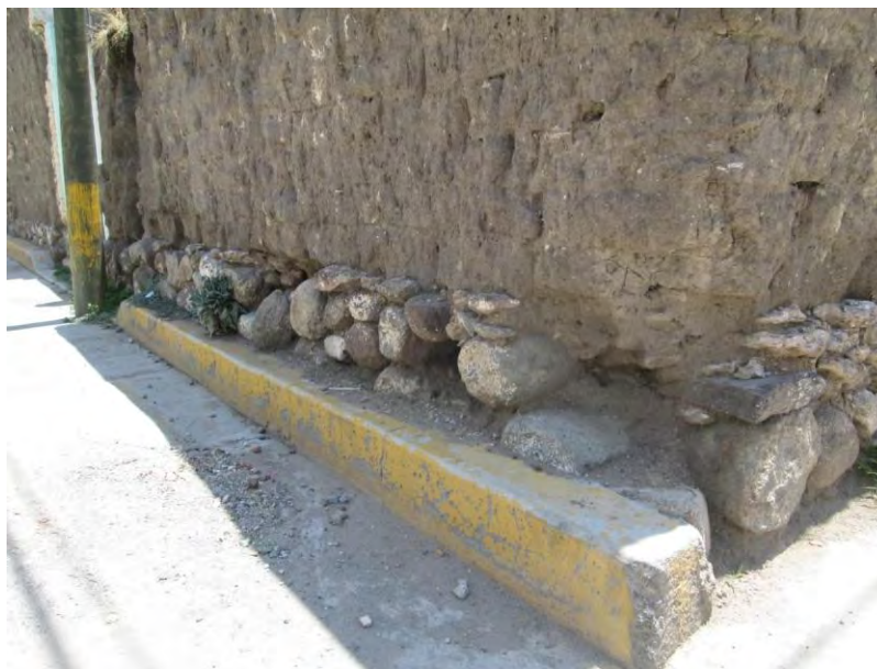
Fotografía 46. Detalle de material disgregado en cimentación
