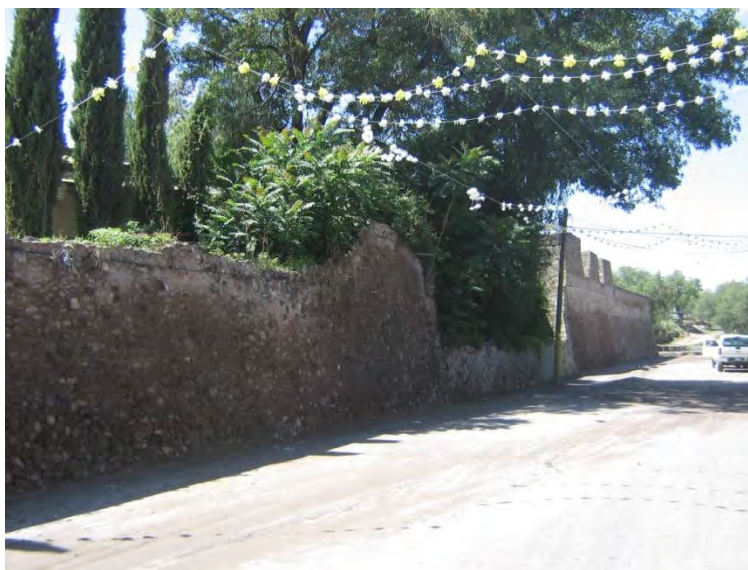
Fotografía 10. Calle Aztecas viendo hacia el puente roto y río Chapingo. Se puede apreciar que la falta de planes de manejo provoca la pérdida y el deterioro, por ejemplo aquí vemos la falta de un tratamiento de piso adecuado, la aparición de vegetación sobre el núcleo de la muralla esta provocando que la estructura se deteriore y se puede perder, por falta de acciones y planes de manejo, se requiere de la liberación de la vegetación nociva que tiene su raíz sobre los vestigios de la muralla prehispánica.
