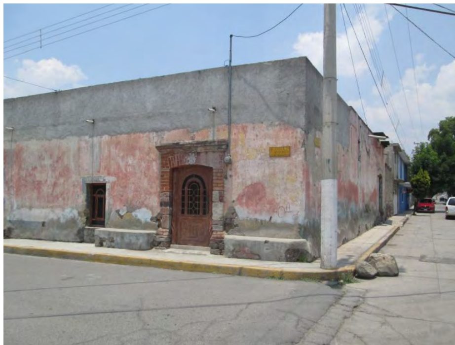
Fotografía 69. Se presentan humedades ascendentes en los paramentos exteriores
