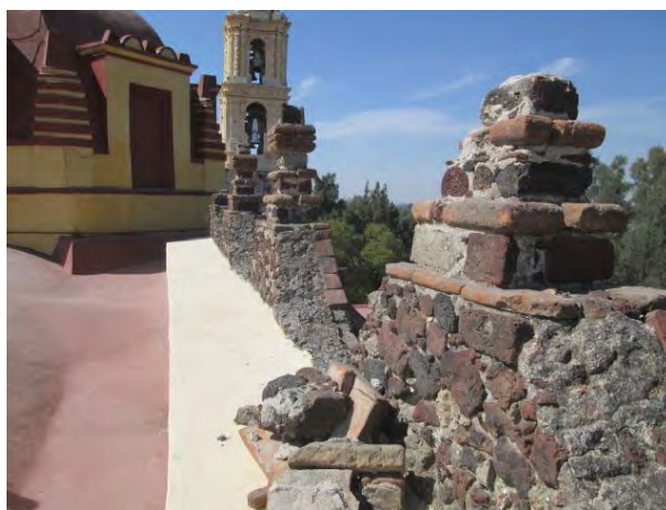
Fotografía 184. Se presenta el desplome de un pináculo
