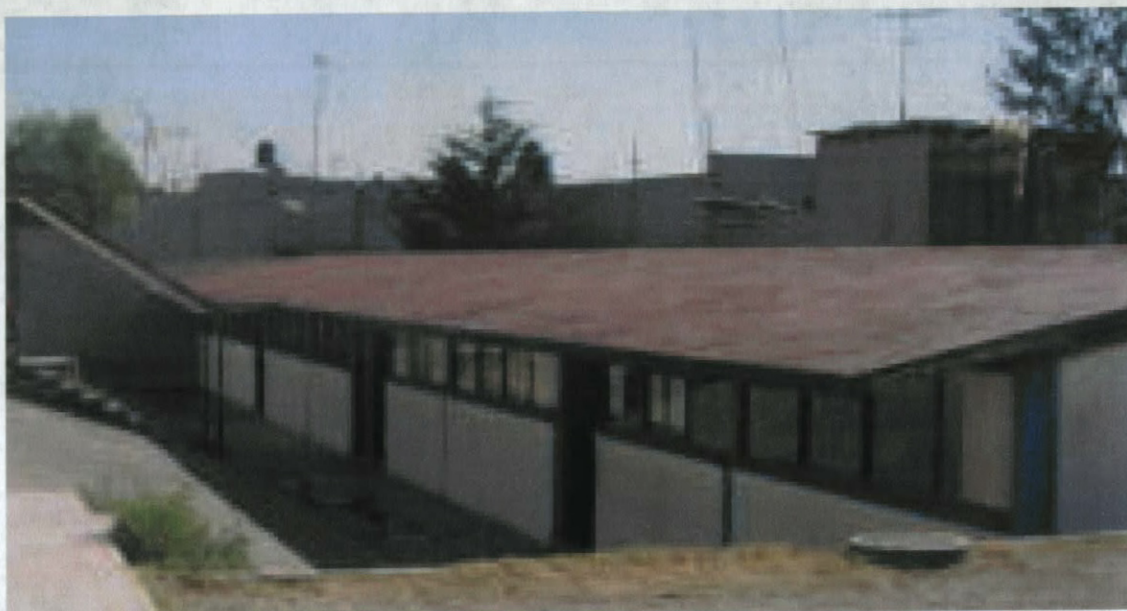
Figura 28 4ª Terraza: salones de quinto grado(izq.), y salones de sexto grado(der.) Fachada norte. Lugar: Col. Valle Dorado, Naucalpan, Edo. Méx. Fecha: Nov.2001 Hora: 11:20 Hrs.
