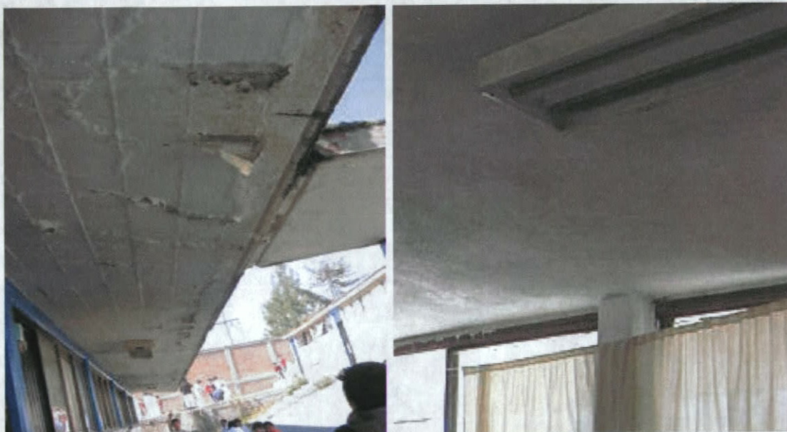
Figura 33 y 34 Deterioro del plantel por falta de planeación y mantenimiento Lugar: Col. Valle Dorado, Naucalpan, Edo. Méx. Fecha: Nov.2001 .
